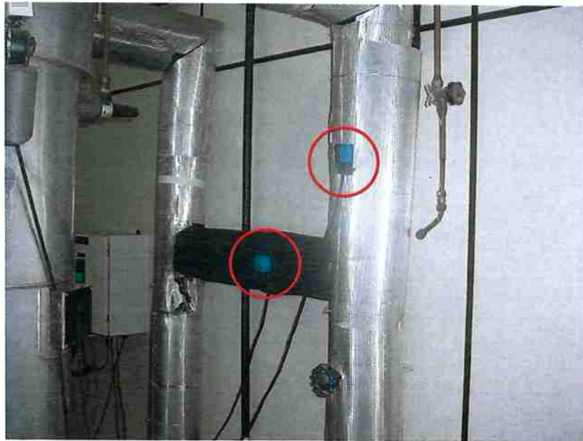
Figura 5.2. Montagem das válvulas solenoides para o controle da pressão de baixa.
