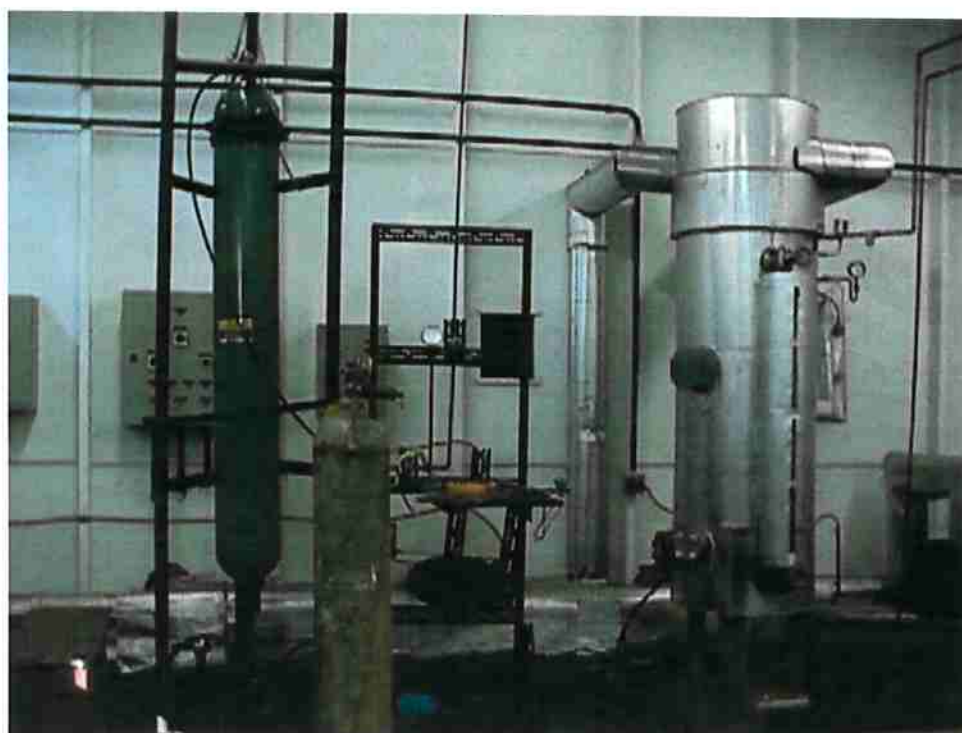
Figura 4.3. Reservatório de baixa pressão (á direita) e pressurizador de 50 litros da montagem original.
