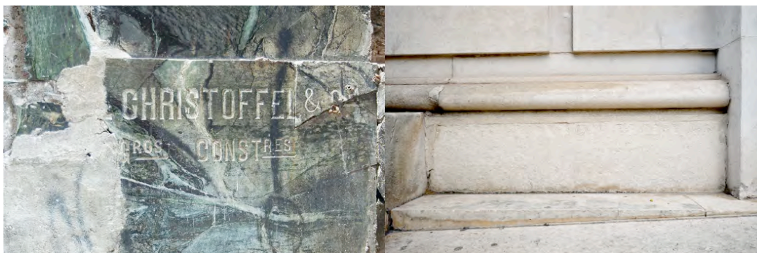
Figura 13. Epígrafes arquitetônicas danificadas em São Paulo (foto de Haroldo Gallo), e em Londres (foto de Priscila Farias).
