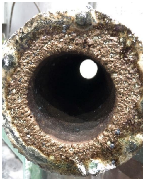
Figura 17 - Foto do tubo após o uso, com desgaste no diâmetro interno, com a medição do diâmetro interno em 87,1 mm.
