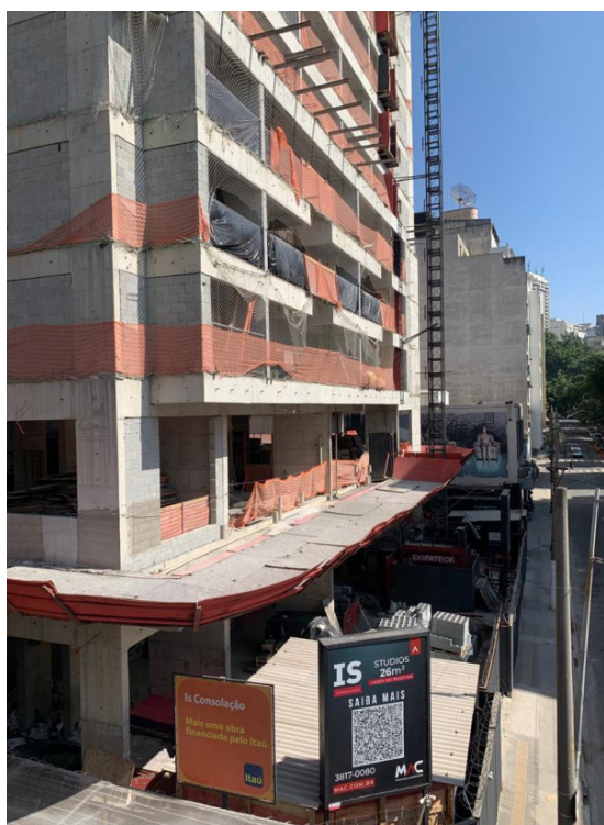
Imagem 122. Prédio em construção no entorno do Minhocão. Sua construção ocultou parte do mural de Apolo Torres. Foto do autor.
