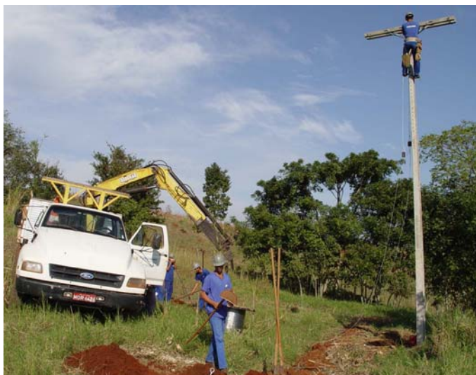
Figura 9.12 Turma da Santa Cruz na construção dos ramais em Taguaí – SP no Luz para Todos
