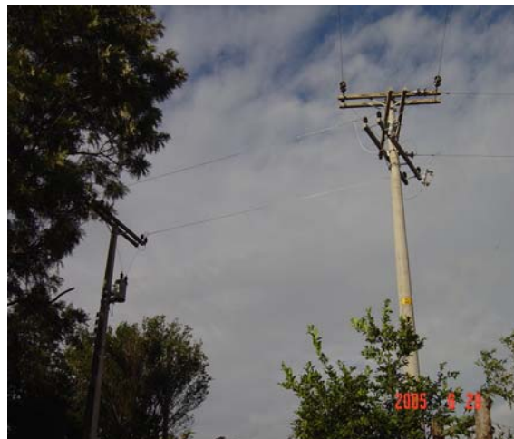
Figura 10.6 Vista lateral da Figura 10.5 - aproveitamento e derivação para ligar Propriedade no Luz para Todos
