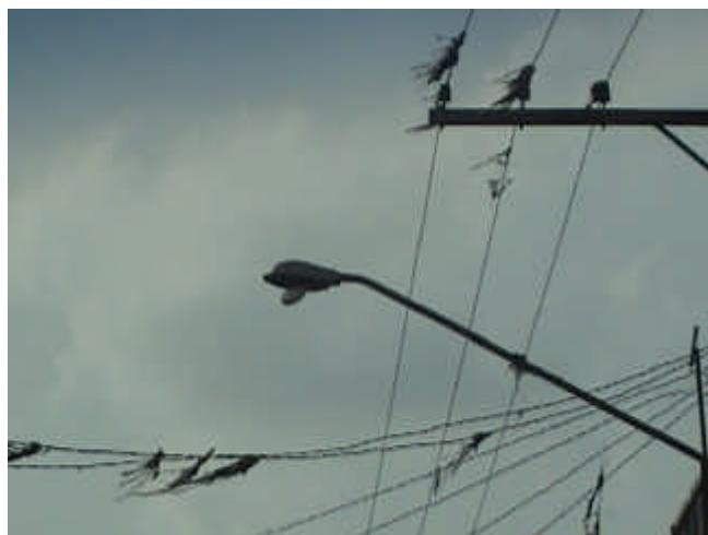
Figura 3.4 – Imagem de instalação na cidade de São Paulo, Capital, resultado do fim do ciclo de vida de componente (não identificado). Foto do autor, 2001.
