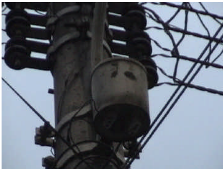
Figura 2.24 – Reator série externo típico (para lâmpada HID), instalado em poste com circuito secundário da distribuição de energia elétrica. Fonte: foto do autor na cidade de Limeira, SP, 2000.
