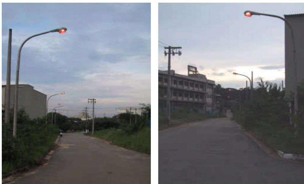
Figura 2.41 – Vistas diurna da via na CUASO/USP onde o experimento foi realizado (à esquerda, do local onde o usuário ficou posicionado; à direita é o sentido oposto). As luminárias são originais da instalação (VSAP 150 W).
