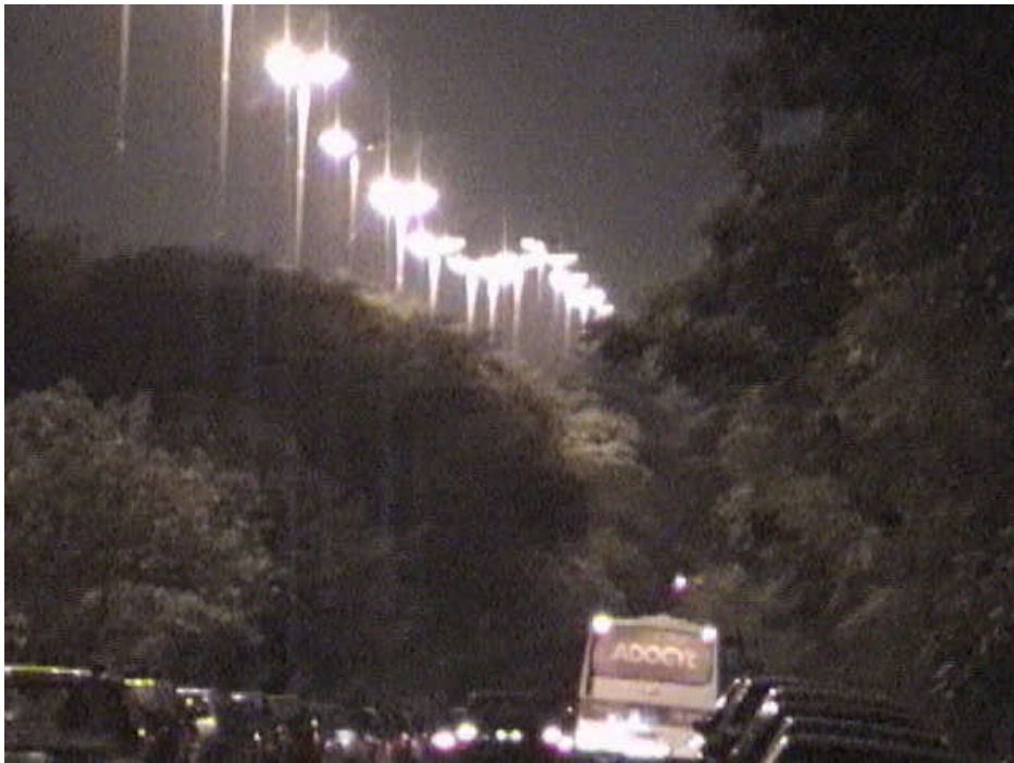
Figura 2.27 – Luminárias para lâmpada HID, no CUASO/USP, instaladas em altura elevada (20 m), circuito de alimentação subterrâneo e independente dos postes da distribuição de energia elétrica. Foto do autor, 2001.
