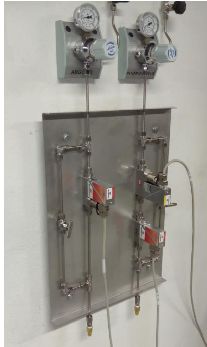
Figura 20 - Sistema de controle de pressão e vazão de gases Bronkhorst.
