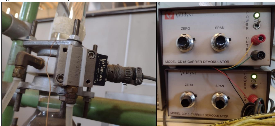
Figura 15 – Medidores de pressão diferenciais
