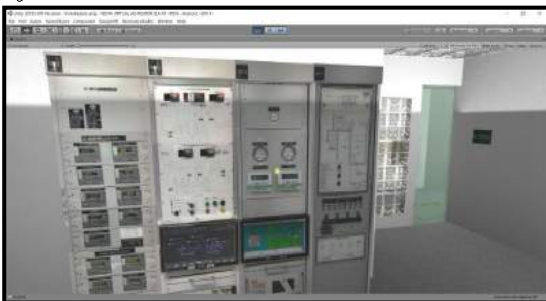
Figura 50 – Racks de monitoramento do reator IEA-R1
