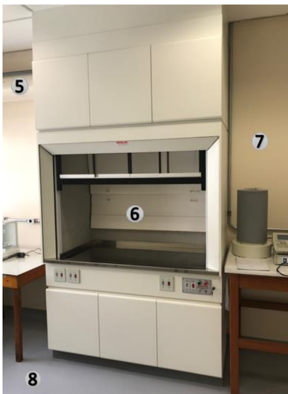
Figura 20 – Modificações e instalações realizadas para manuseio de fontes radioativas. 5 - Tubulação de exaustão; 6- Capela (com dimensões de 1,5 \times 0,755 \times 2,63 \text{ m}^3 ); 7 -Paredes lisas, sem ranhuras, pintadas com tinta lavável e não porosa; 8- Piso de epóxi autonivelante e selado.
