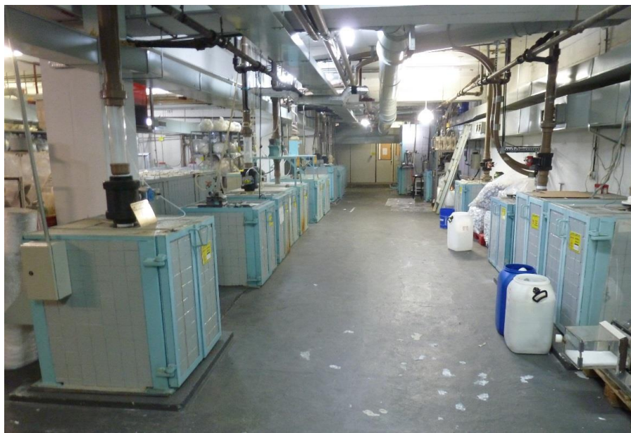
Figura 18: Porão do CR - IPEN com destaque para os tanques de armazenamento de rejeitos radioativos.
