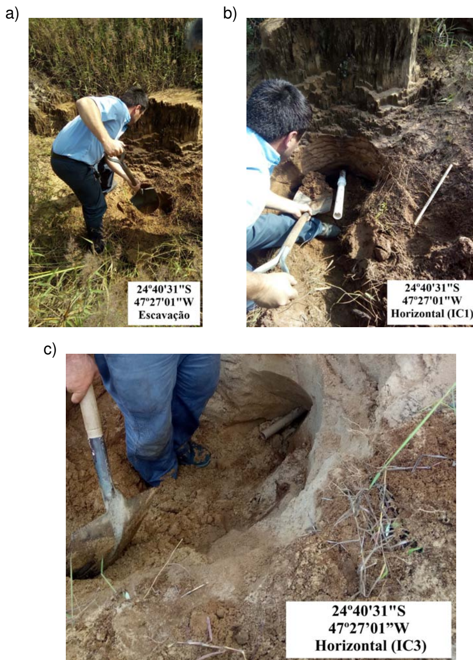
Figura 18 – (a) Escavação do local, (b) Perfil e inserção do tubo IC1 e (c) Perfil e inserção do tubo IC3
