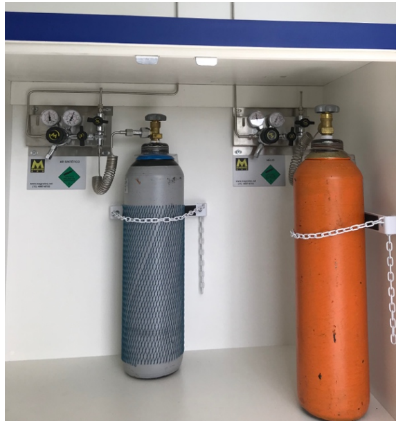
Figura 20. Cilindros dos gases exigidos para o funcionamento dos equipamentos analíticos que foram instalados na parte interna da bancada.
