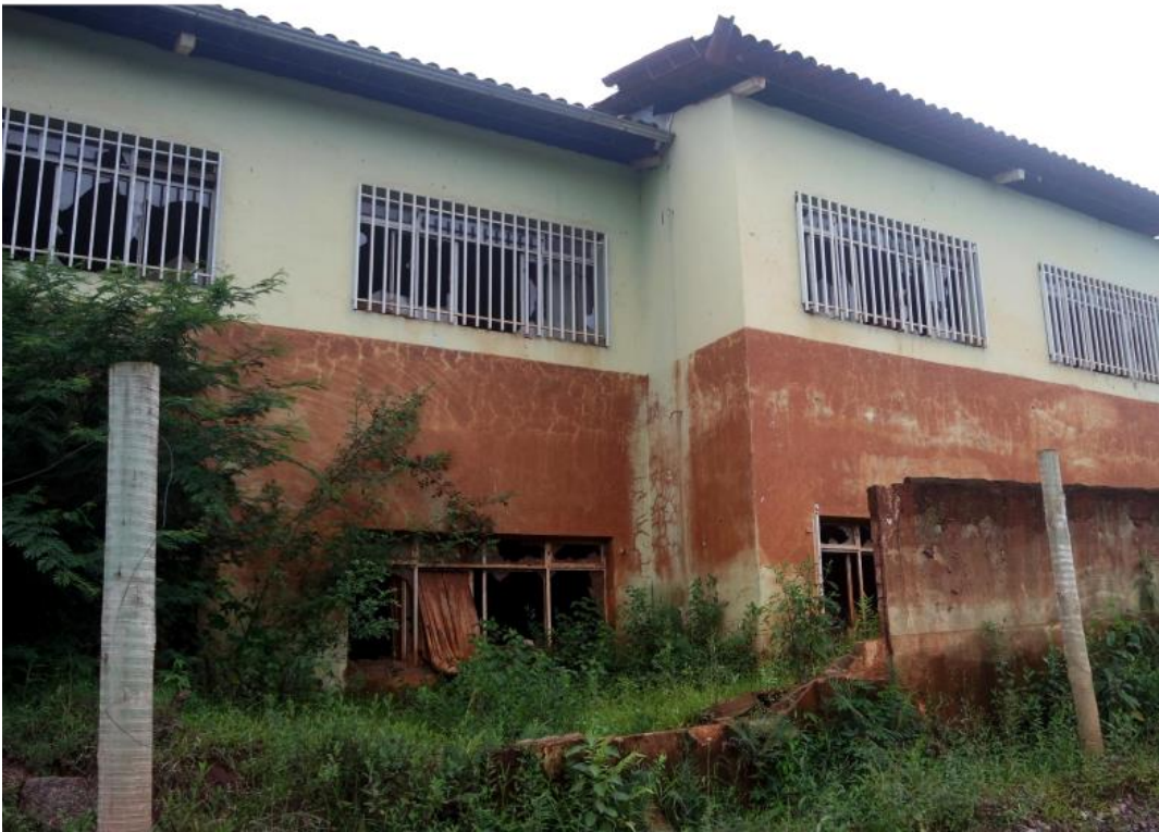
Fig. 4 - Paracatu de Baixo. Marcas na parede da escola demonstram a altura que a lama atingiu
