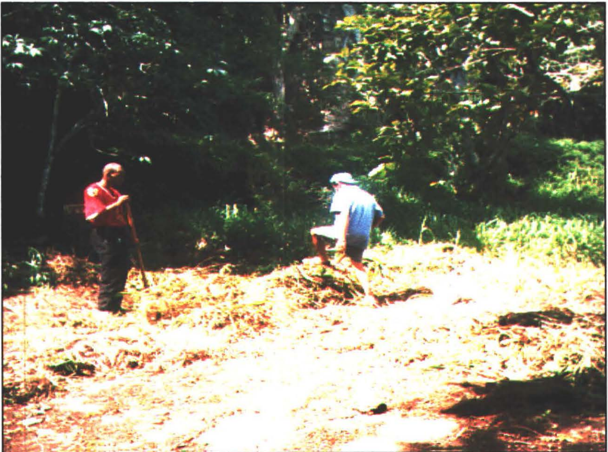
Foto 15. - Limpeza da área B próximo ao Canal na lateral leste da Igreja .
