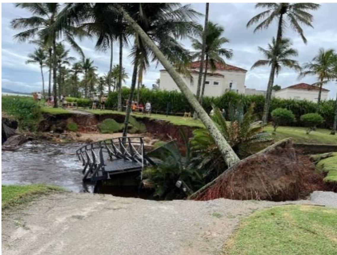
Figura 12 – Ressaca e avanço da maré sobre áreas ajardinadas e ruas, fevereiro de 2023
