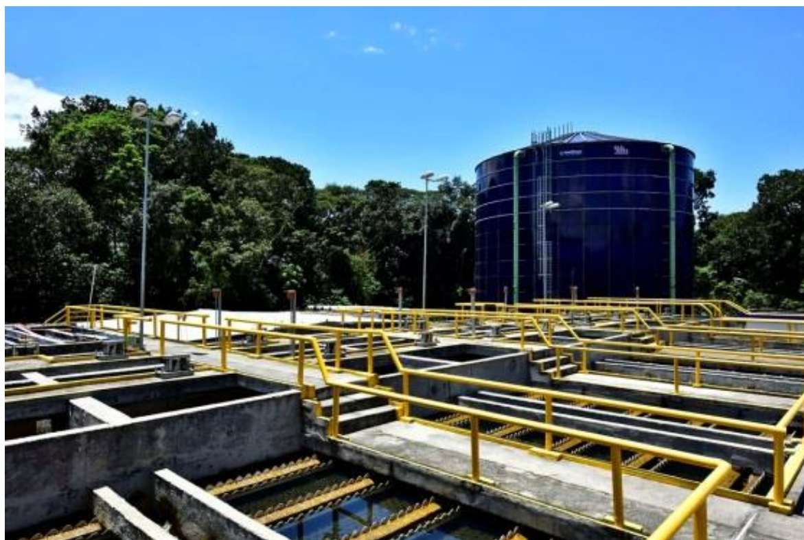
Figura 24 – Estação de Tratamento de Água
