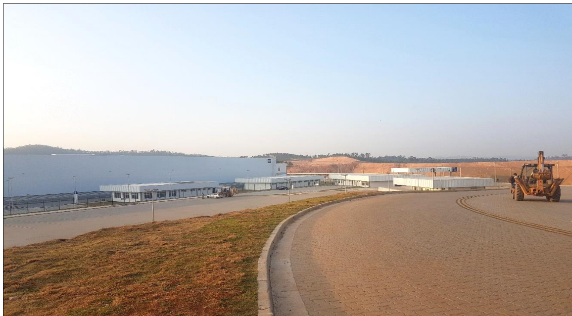
Figura 29 - Centro de distribuição do Mercado Livre em construção em Franco da Rocha (2022)
