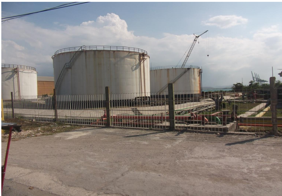
Foto 14: Central Termoeletrica Máximo Gomez. Empresa de capital 100% cubano responsável pela geração e distribuição de energia para o sistema nacional. Por Ana Sylvia Maris Ribeiro, maio de 2019.
