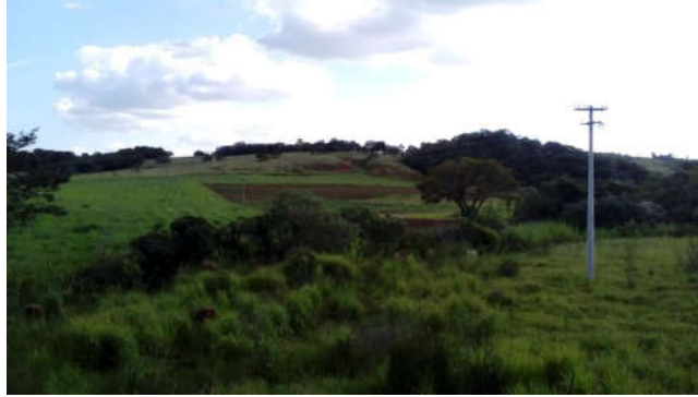
Figura 25: Morro de declividade muito alta com solo exposto por erosão em sulcos.
