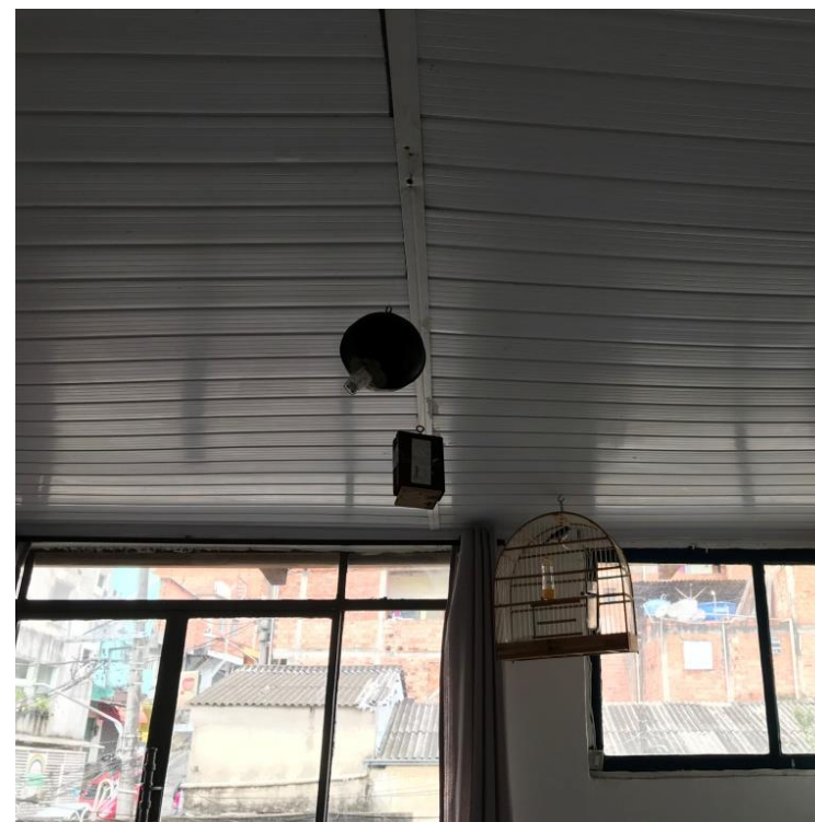
Figura 28 - Local de instalação dos equipamentos na casa 3.
