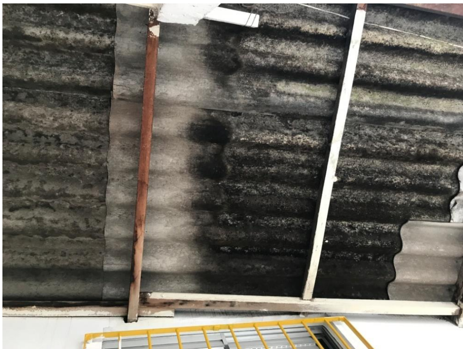
Figura 27 - Placas de fibrocimento que cobrem a casa 3.
