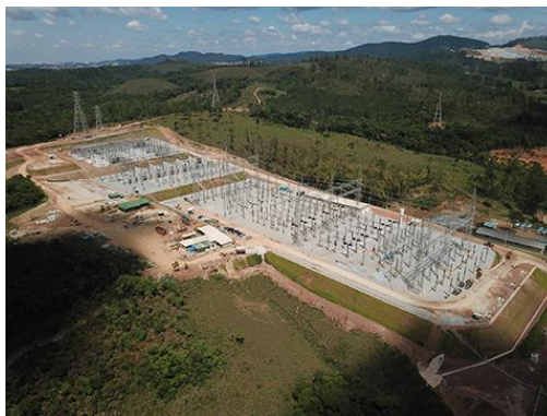
Figura 39 – Subestação Água Azul
