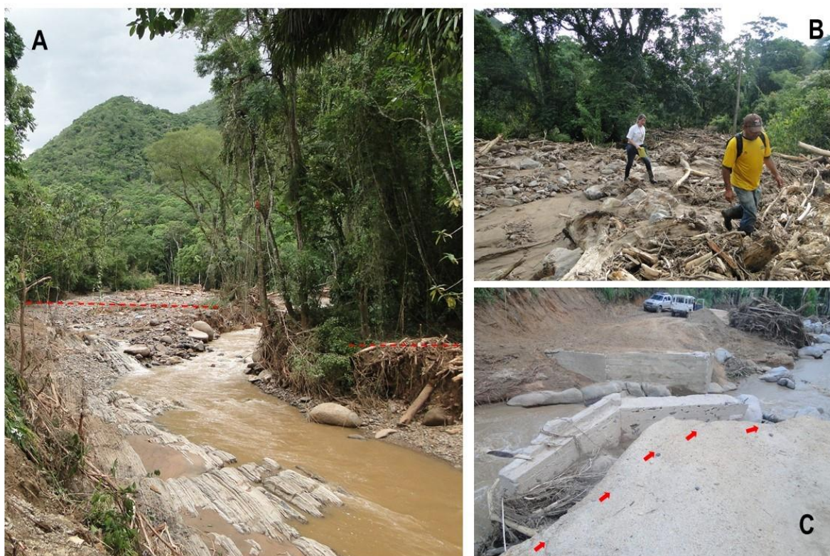
Figura 16: Características das Inundações bruscas e indicação de alguns pontos de sua delimitação, na altura dos cursos alto e médio do rio Palmital. Em (A) destaca-se o alargamento do canal durante o processo, com a deposição de detritos. Em (B) buscou-se observar a baixa ordenação dos depósitos transportados, bem como a presença do aporte vegetal. (C) Indica a direção das inundações bruscas que arrastaram a ponte do bairro do Lageado.
