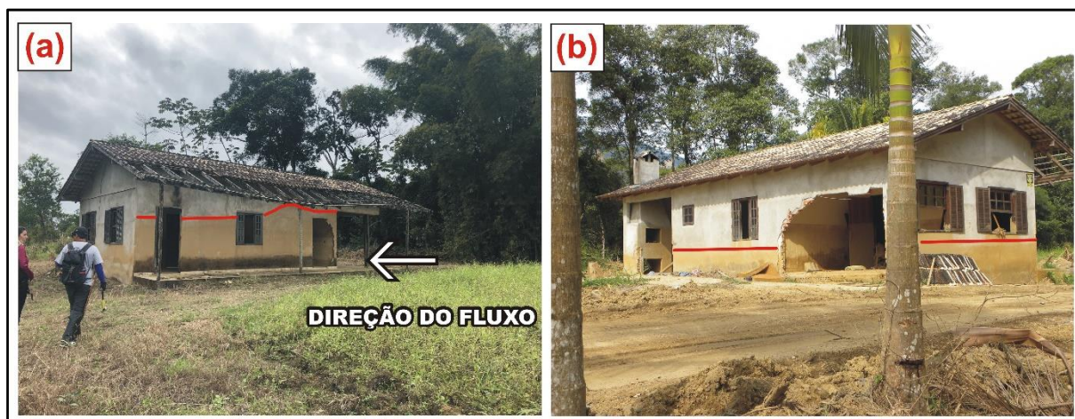
Figura 4.21: Moradia parcialmente destruída pela corrida de detritos na bacia Jacareí, com destaque em vermelho para a altura do fluxo. (a): imagem atual (2019). (b): registro de 2011.
