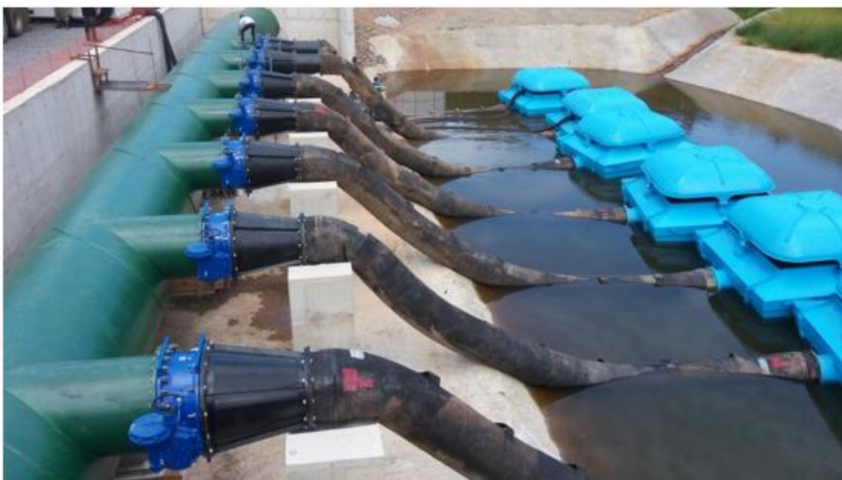
Figura 28 - Bombeamento para a transposição Jaguari - Atibainha em 2014. Fonte: SABESP (2023). Adaptação do Autor.
