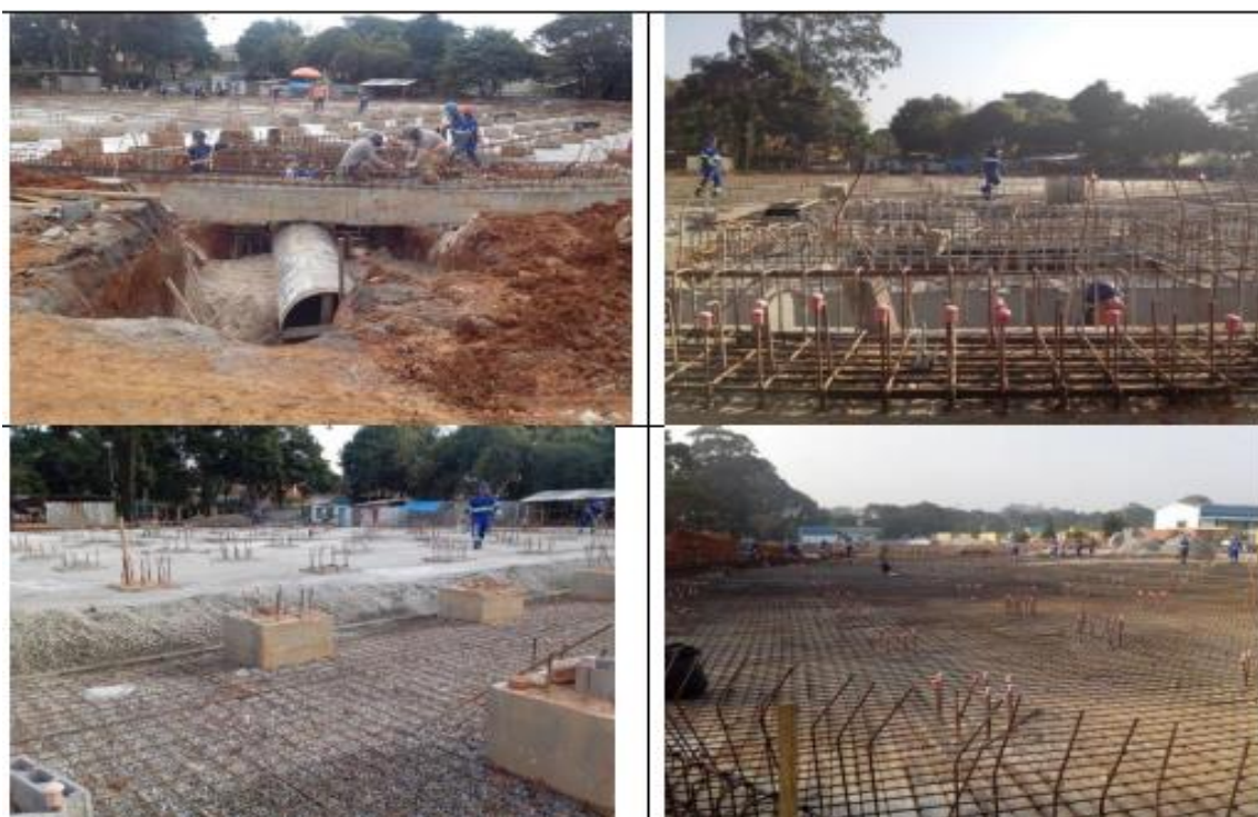
Figura 30 - Obras para implementação da Estação de Tratamento de Água Rodolfo José Costa e Silva (Sistema Guarapiranga) em 2014. Fonte: SABESP (2014). Adaptação do Autor.
