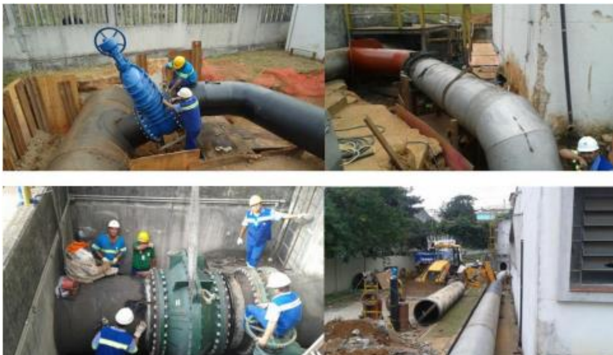
Figura 29 - Obras de adução do Sistema Alto Tietê em Cangaíba – SP em 2014. Fonte: SABESP (2014). Adaptação do Autor.
