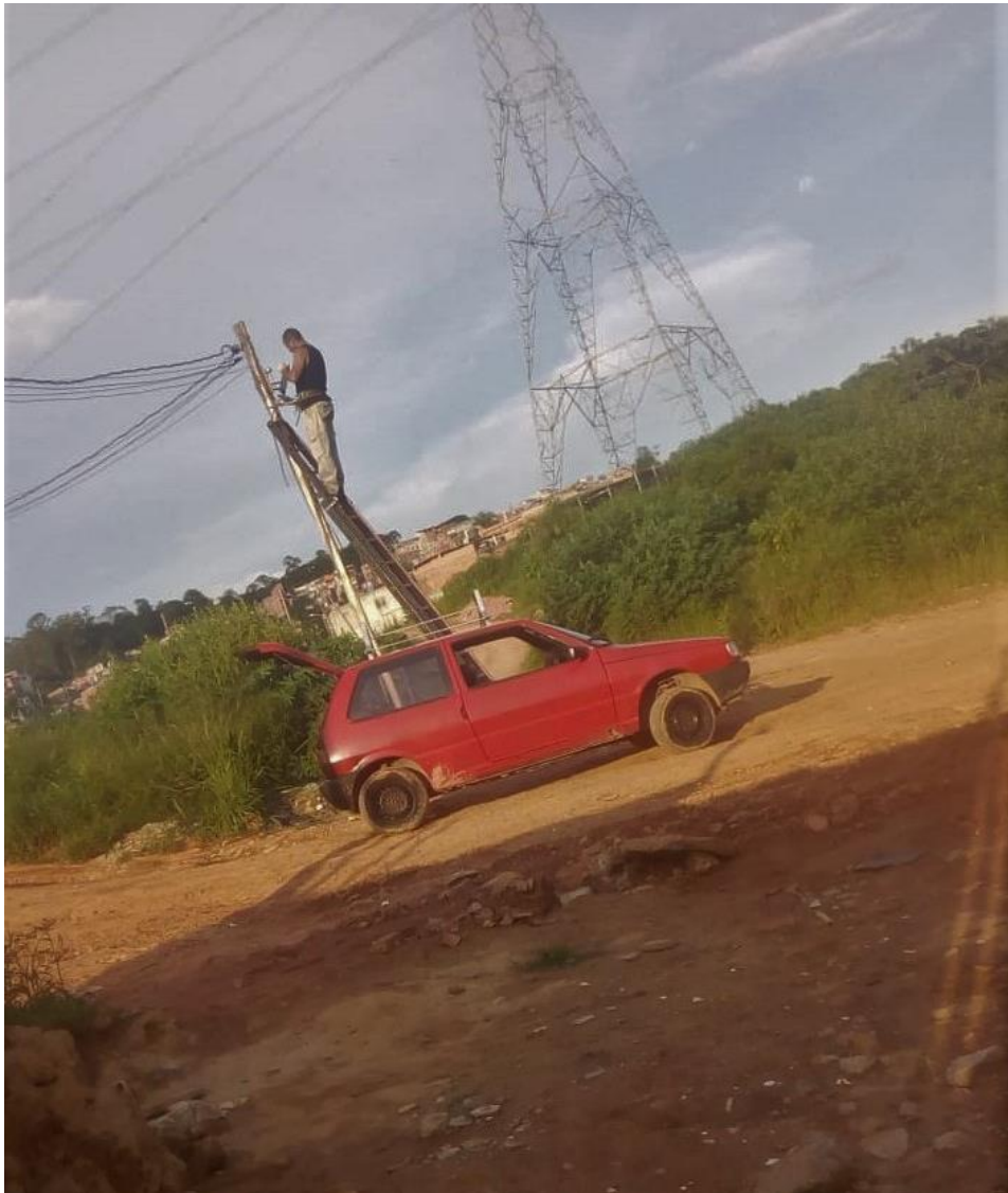
Figura 29 – Homem faz reparo na rede elétrica do Jardim Milão em março de 2019
