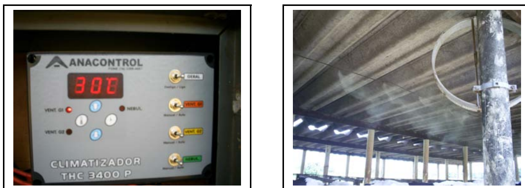
Figura 07 - Sistema de climatização instalado no free-stall
