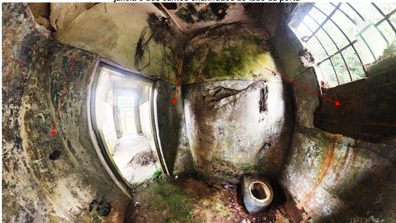
Figura 23: Solitária 03 - Detalhes do estado de conservação. Destaque para intervenção da janela e dos cantos chanfrados ao lado da porta
