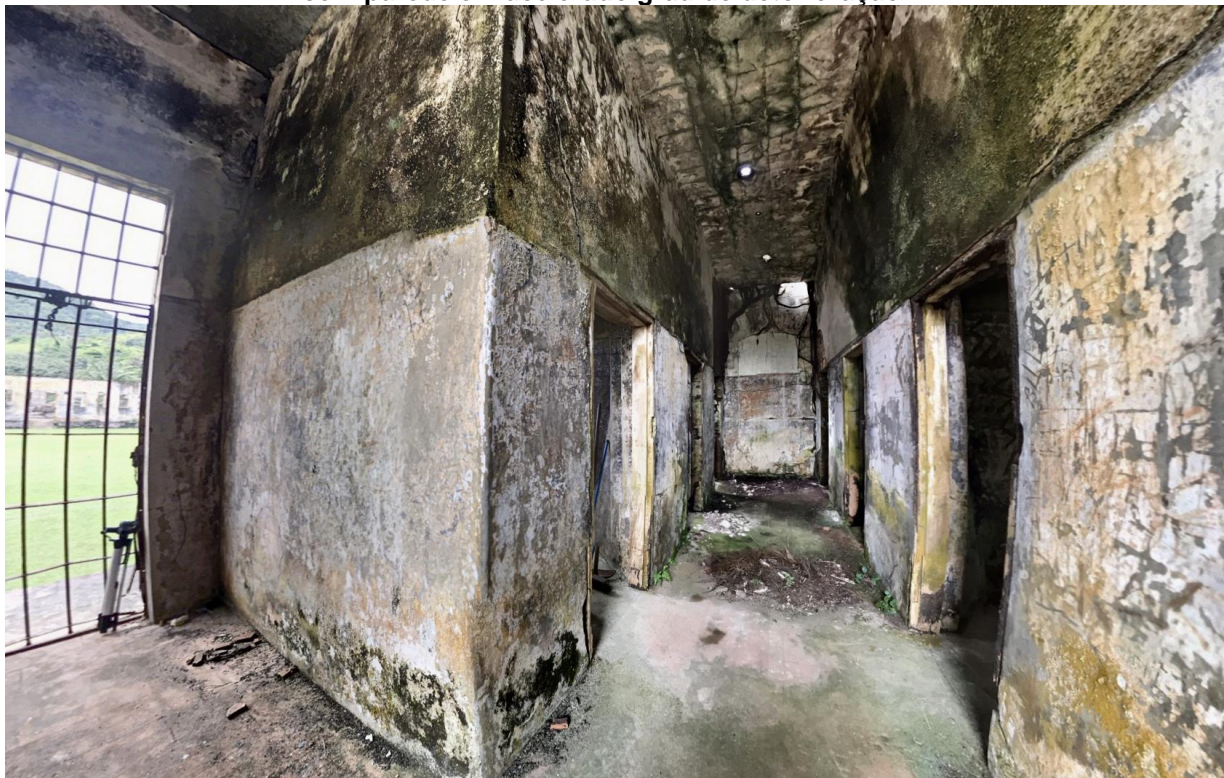
Figura 22: Vista sudeste das solitárias em 180°. Do lado direito celas 09 (a), cela 07 (b) e cela 05 (c) e do lado esquerdo cela 08 (d), cela 06 (e) e cela 04 (f). Destaque para o fim do corredor com parede em acelerado grau de deterioração
