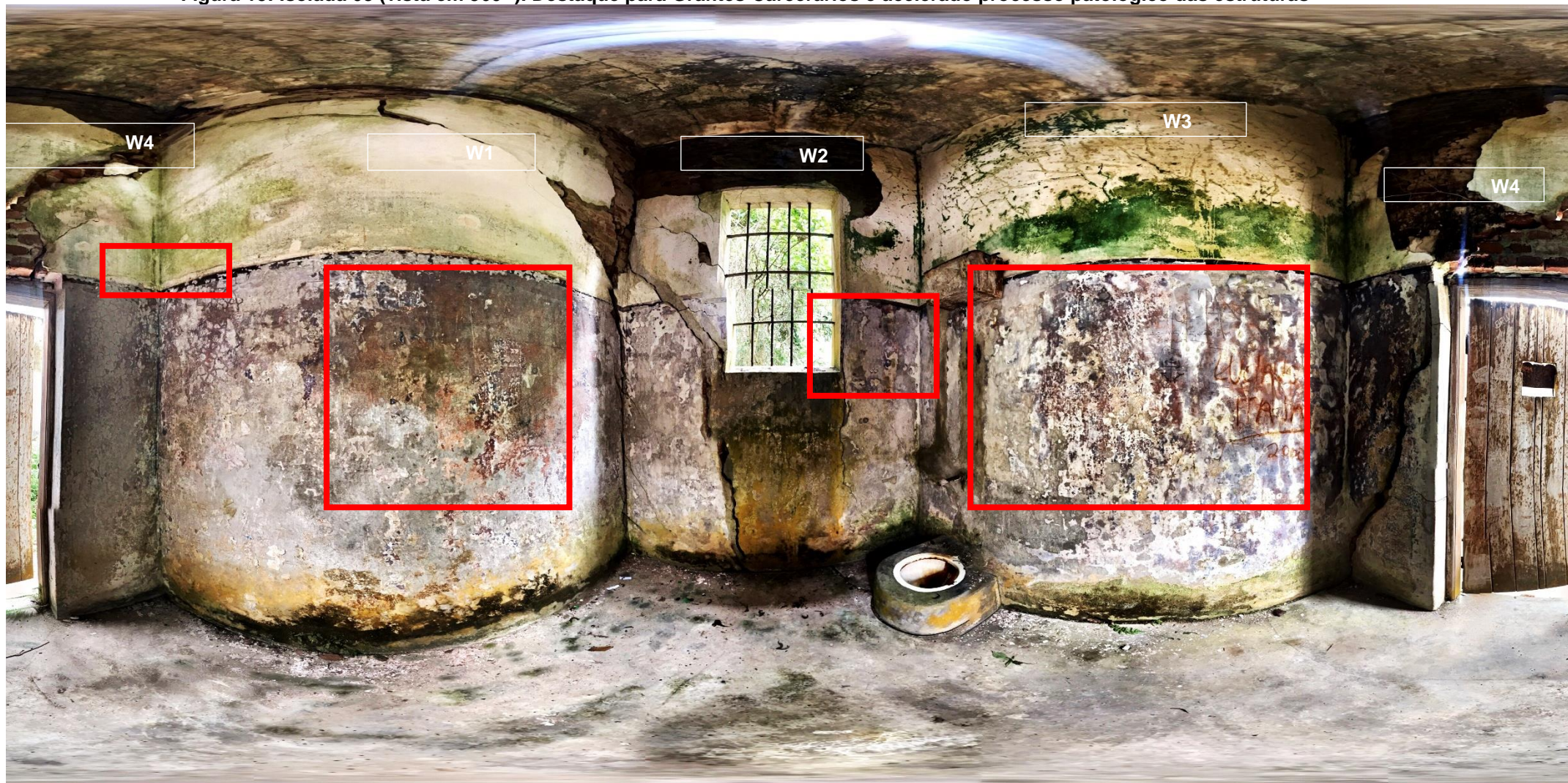
Figura 15: Isolada 08 (vista em 360 °). Destaque para Grafites Carcerários e acelerado processo patológico das estruturas
