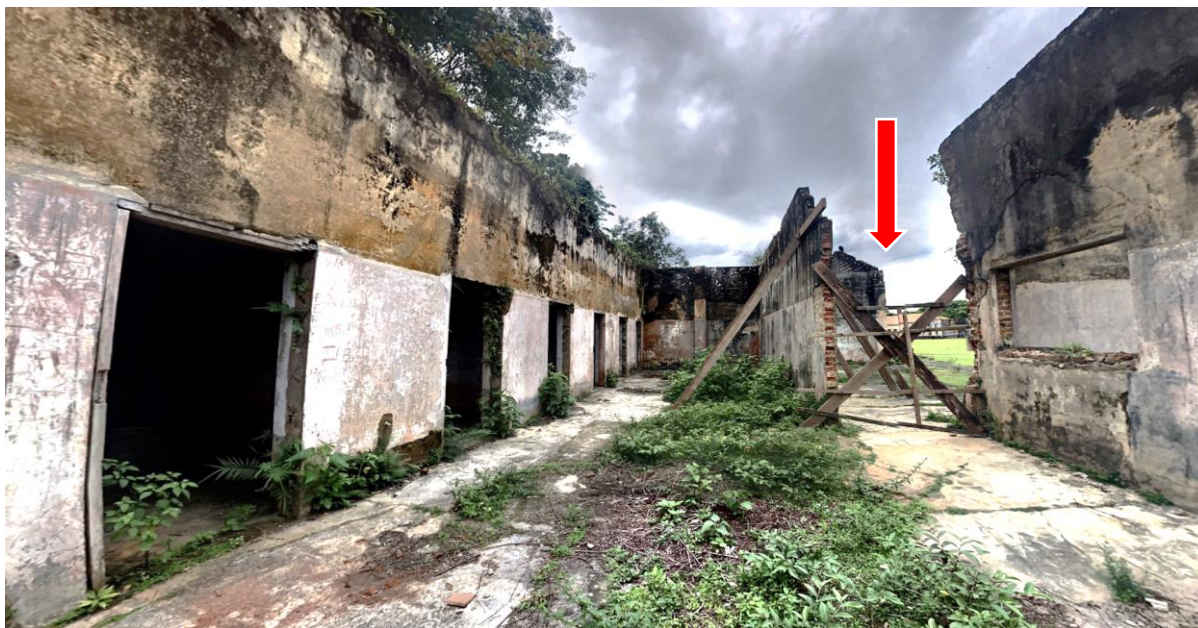
Figura 13: Vista interna em 180° da parte externa do conjunto de isoladas. Destaque para o acesso bloqueado com vigas e para o crescimento de vegetação em suas estruturas
