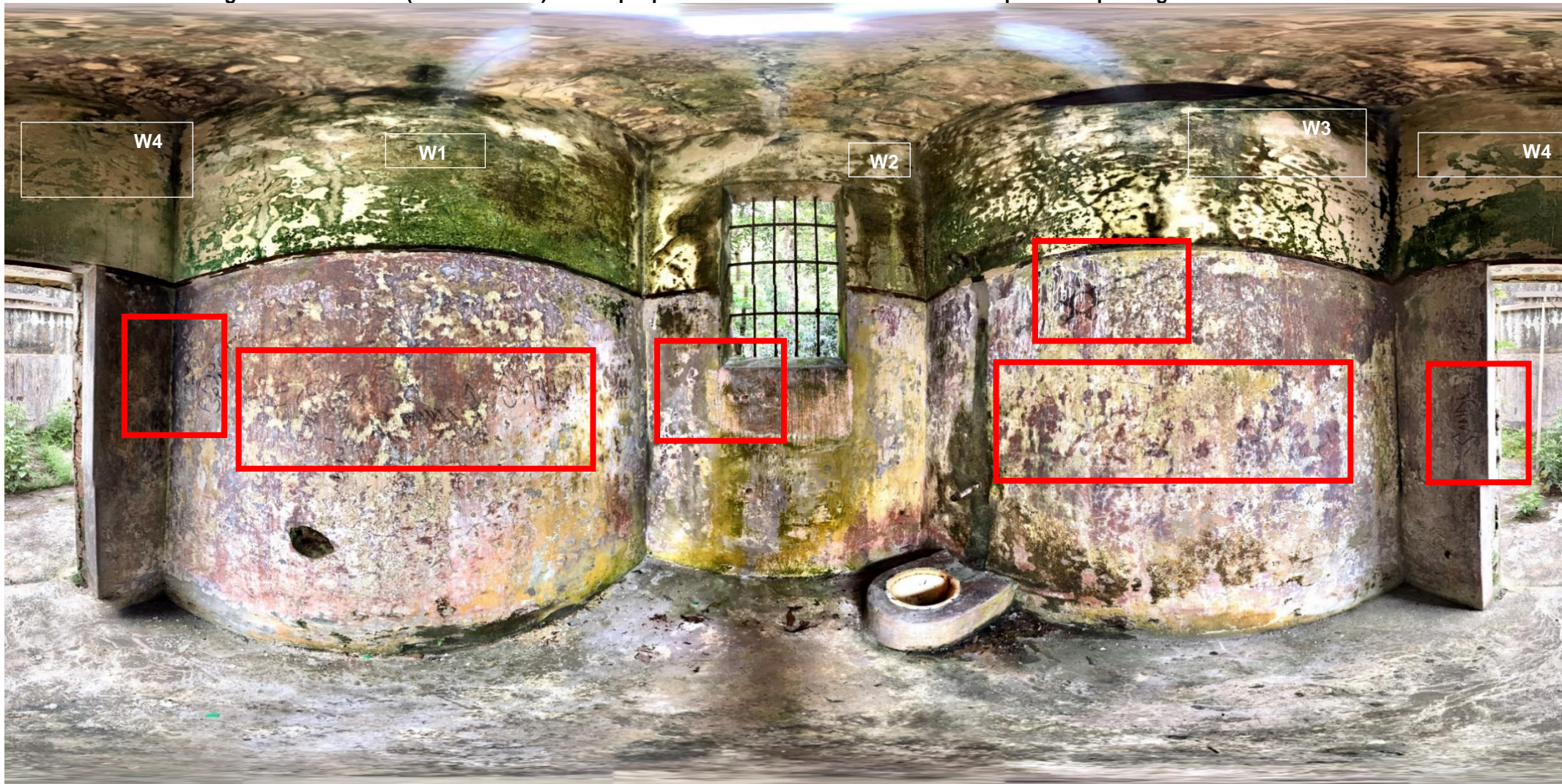
Figura 14: Isolada 02 (vista em 360 °). Destaque para Grafites Carcerários e acelerado processo patológico das estruturas
