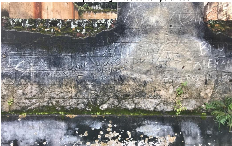
Figura 8: Parede do Pavilhão 01 (vista externa). Destaque para as patologias de alvenaria e para os grafites contemporâneos
