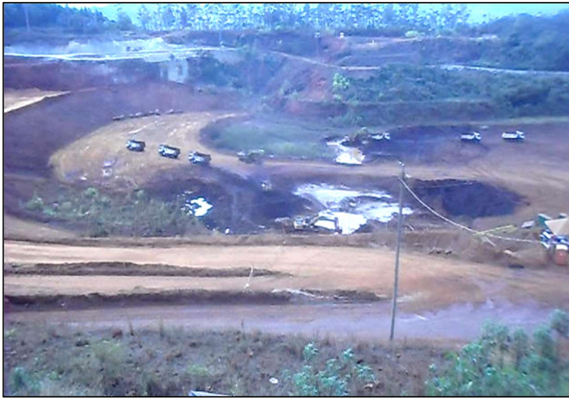
Figura 102 - Obra de descaracterização das barragens B3 e B4 em Nova Lima/MG com a utilização de equipamentos operados remotamente.
