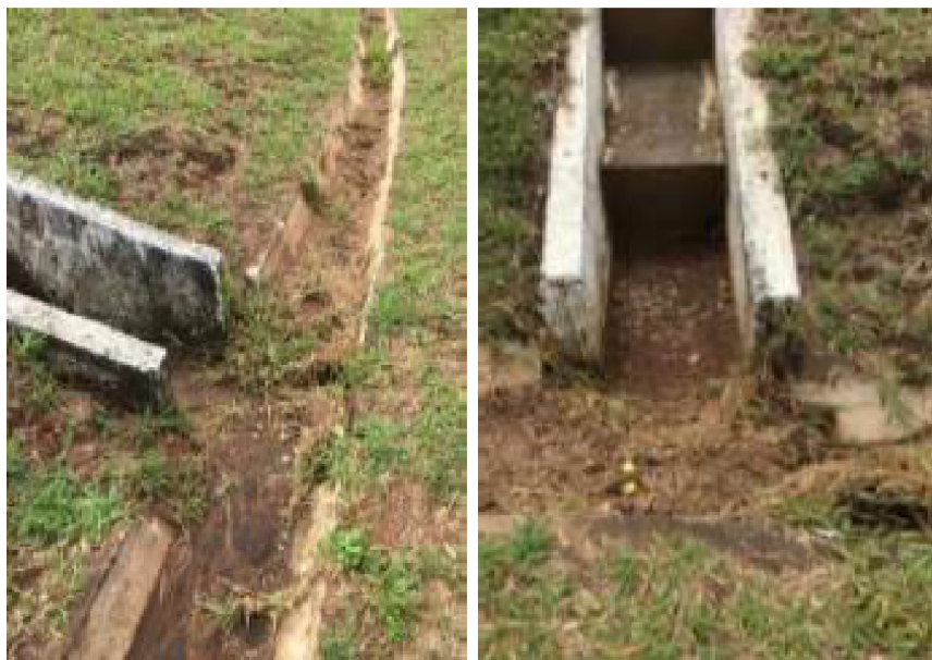
Figura 67 - Canaletas de drenagem superficial na B I obstruídas por sedimentos
