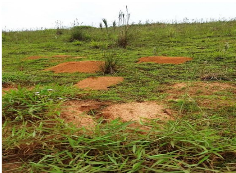
Figura 93 - Formigueiros em taludes da barragem B I
