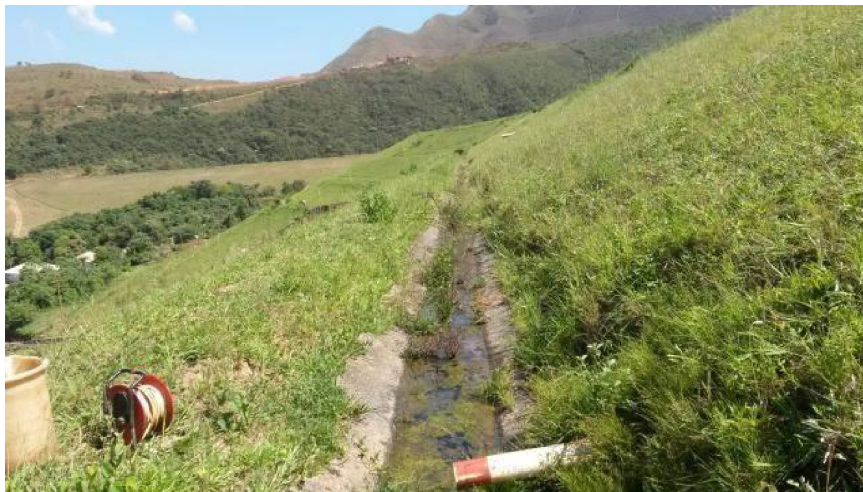
Figura 71 - Canaleta de drenagem assoreada e acumulando água na barragem B I
