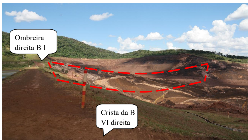
Figura 20 - Visão do local após o rompimento da barragem B I
