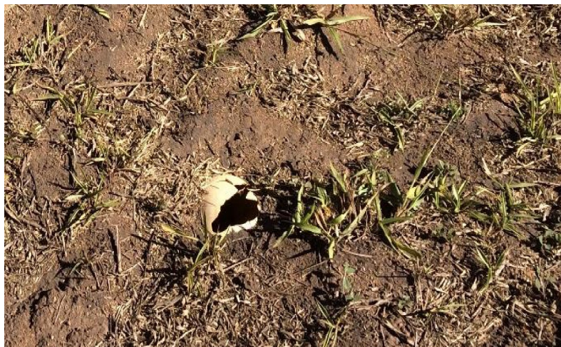
Figura 77 - Tubo da drenagem interna danificado na barragem B I
