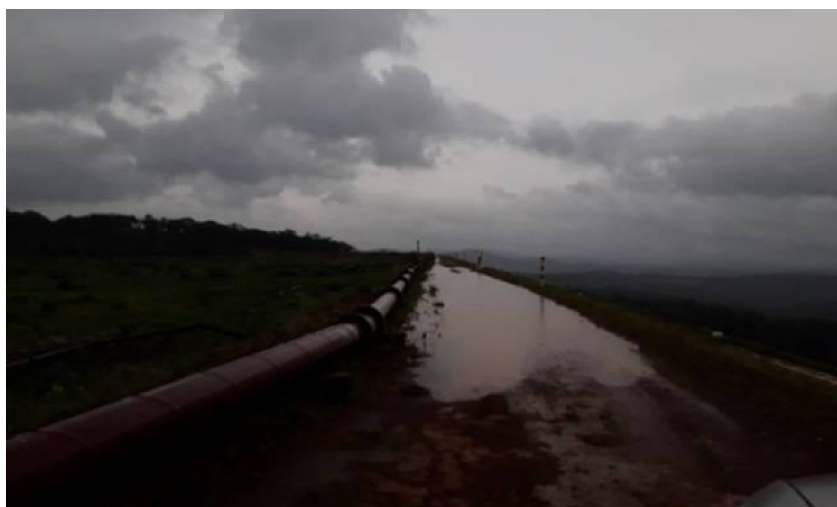
Figura 73 - Acúmulo de água na crista da barragem B I
