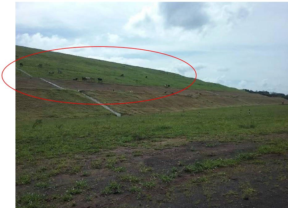
Figura 92 - Presença de gado nos taludes da barragem B I
