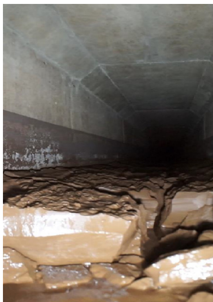
Figura 81 - Vista interna da galeria de fundo da B I, com acúmulo de rejeito mineral
