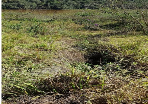
Figura 84 - Bacia de dissipação para a Barragem VI totalmente coberta de vegetação
