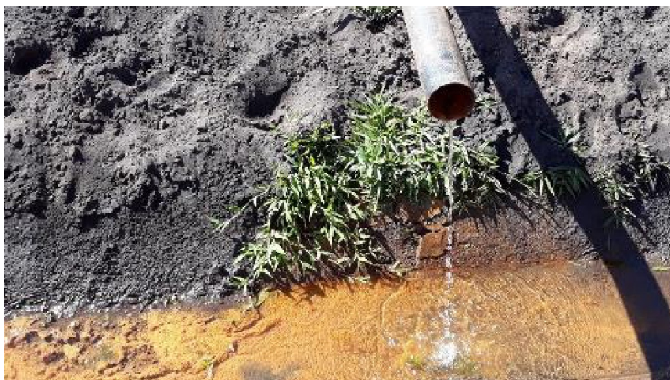
Figura 80 - Escoamento de água em DHP da barragem B I com presença de colóide
