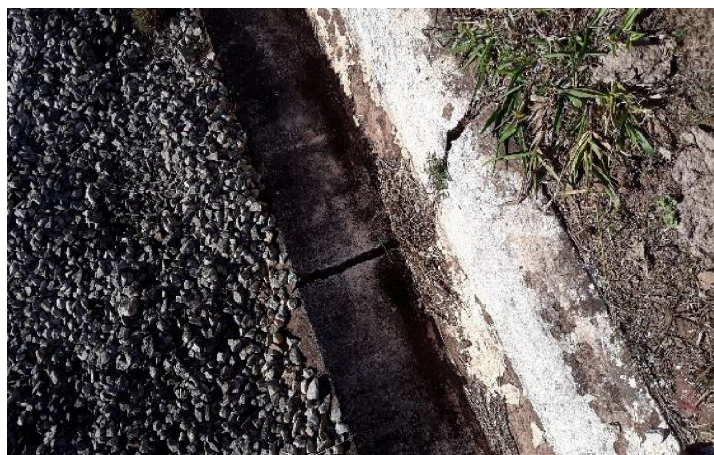
Figura 70 - Trinca em canaleta superficial junto à ombreira esquerda da B I
