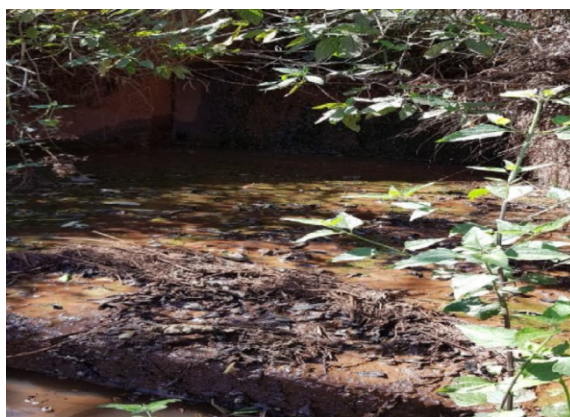
Figura 83 - Detalhe da saída do extravasor da B I, assoreada e com erosão abaixo da laje a jusante
