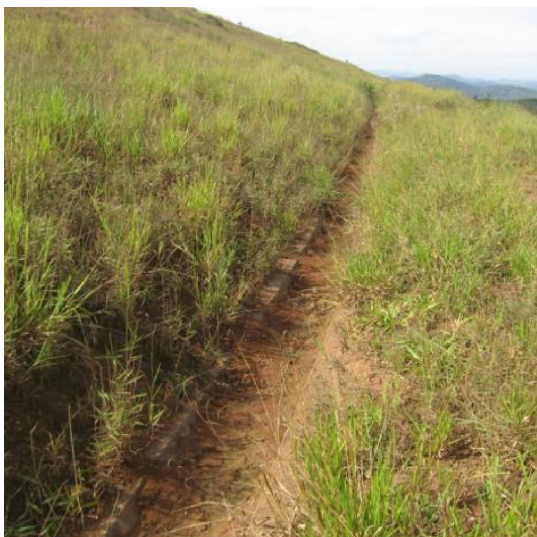
Figura 63 - Canaleta de drenagem assoreada em uma das bermas da B I
