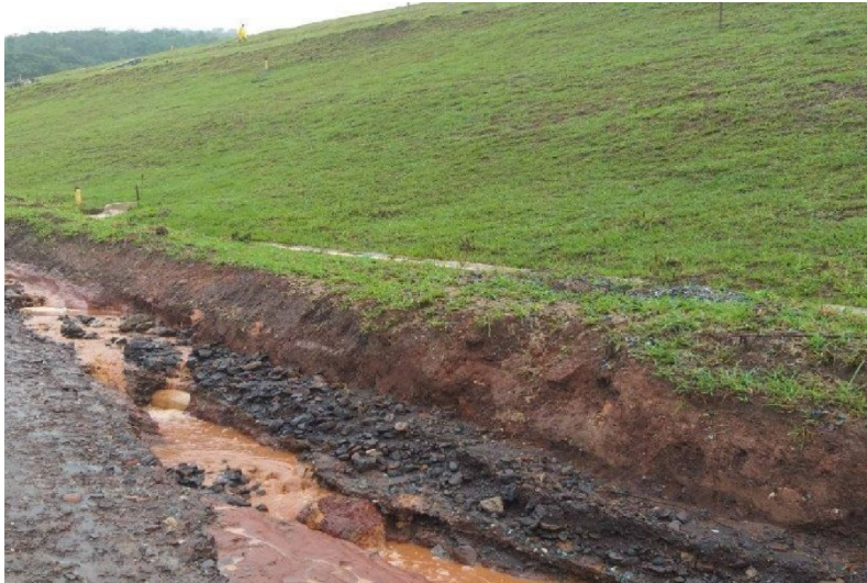
Figura 91 - Erosão no pé da barragem B I devido à drenagem inadequada
