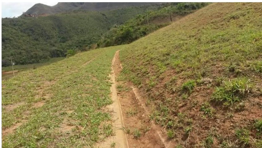
Figura 72 - Canaleta de drenagem superficial assoreada na barragem B I
