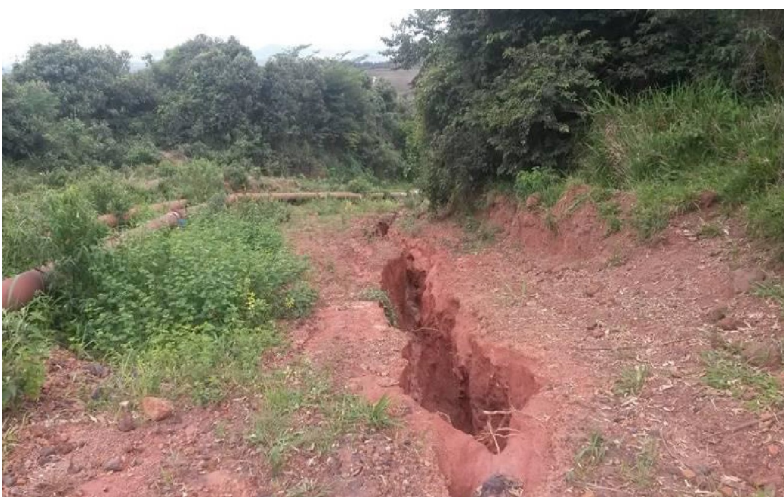
Figura 90 - Erosão no acesso à barragem B I
