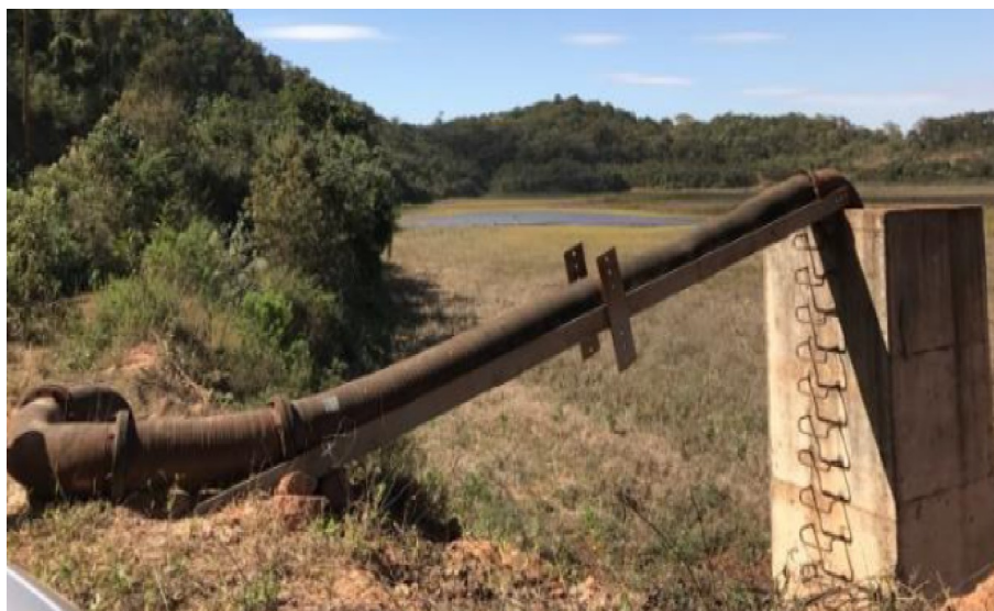
Figura 98 - Tubulação de captação da água do lago (ao fundo) da barragem B I até a torre 3 do sistema extravasor
