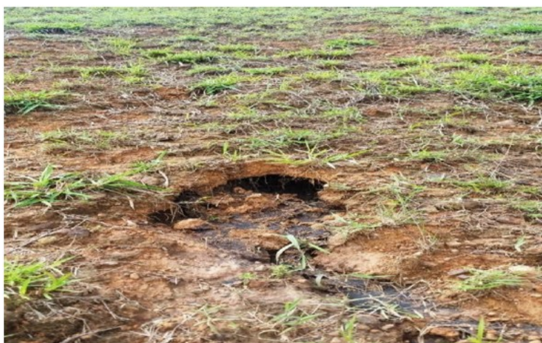
Figura 89 - Erosão (ravina) em talude da barragem B I
