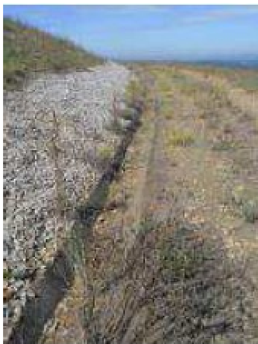
Figura 65 - Canaleta de drenagem superficial assoreada acima da berma de recuo na barragem B I
