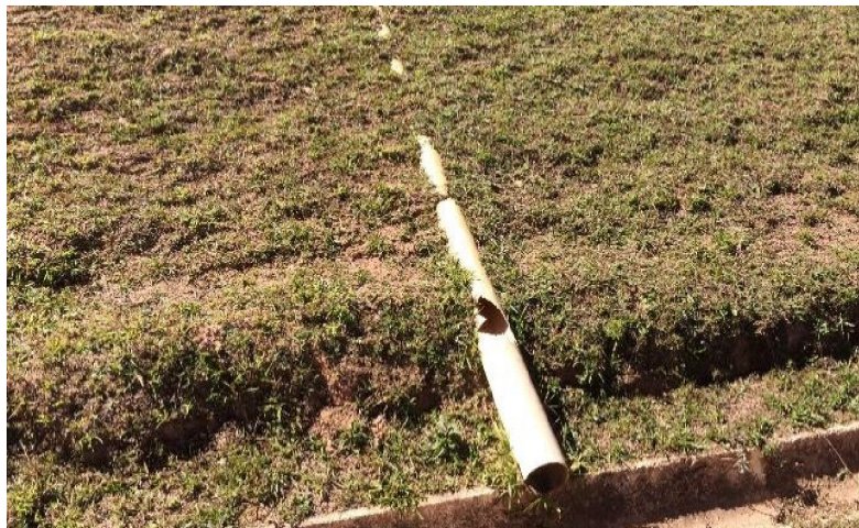
Figura 76 - Tubo da drenagem interna exposto e danificado na barragem B I
