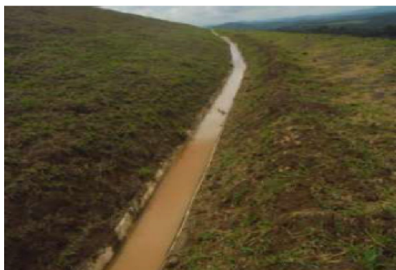
Figura 68 - Canaleta de drenagem superficial na B I com empoçamento de água
