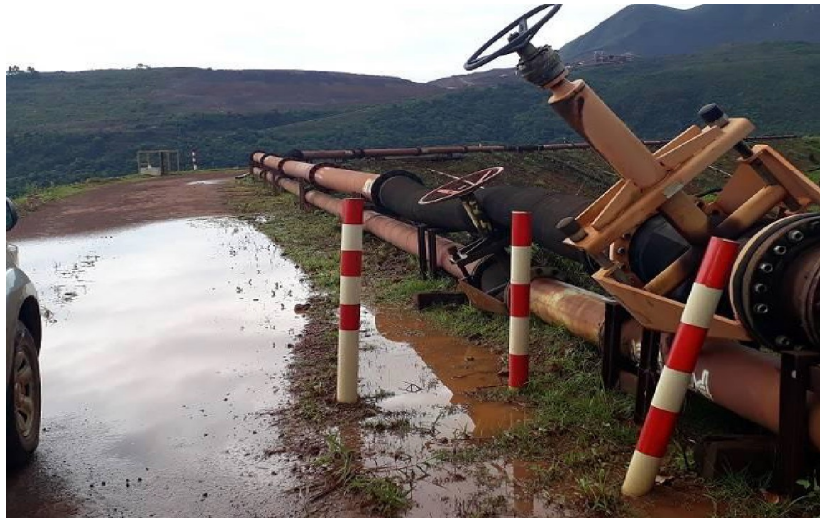
Figura 74 - Acúmulo de água na crista da barragem B I
