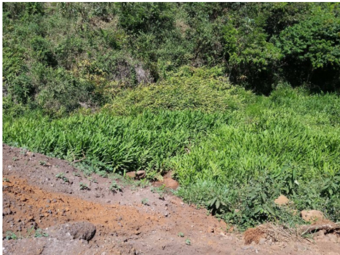
Figura 85 - Vegetação alta no pé do talude da barragem B I
