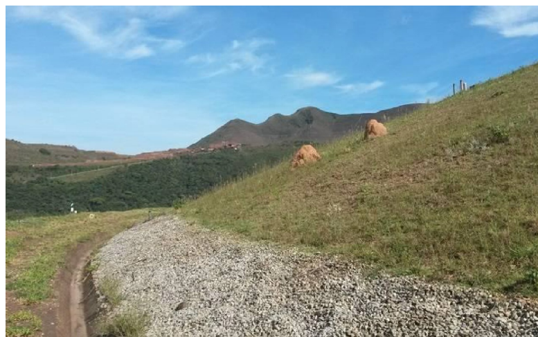
Figura 94 - Cupinzeiros em taludes da barragem B I
