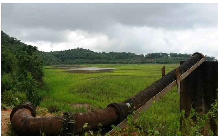
Figura 95 - Formação de lago no fundo reservatório da barragem B I
