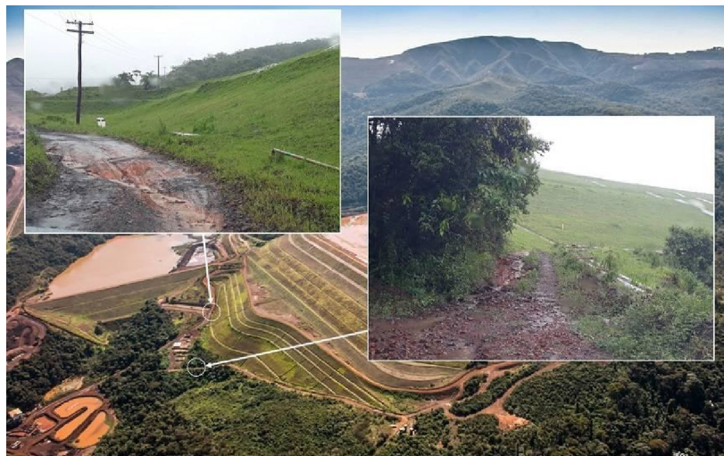
Figura 75 - Drenagem superficial inadequada causando danos em acessos à barragem B I
