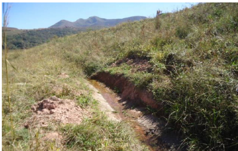
Figura 88 - Deformação no talude acima de uma canaleta de drenagem superficial na barragem B I
