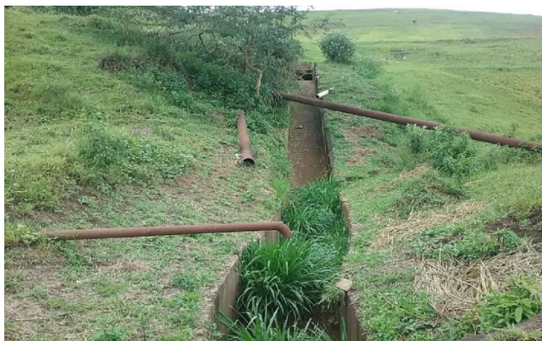
Figura 87 - Obstrução de canal de drenagem por vegetação na barragem B I
