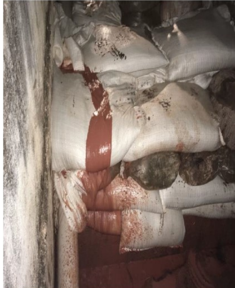
Figura 122 - Vista de sacarias de areia sobre a escada de drenagem da barragem B I em 11/06/2018
