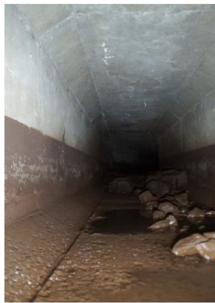
Figura 82 - Vista interna da galeria de fundo da B I, com acúmulo de rejeito mineral
