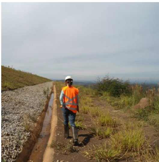
Figura 64 - Empoçamento em canaleta de drenagem superficial da B I
