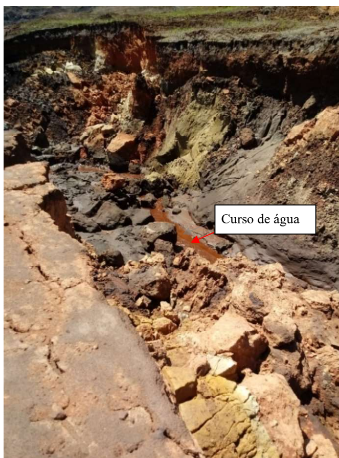
Figura 49 - Depressão no pé da barragem B I com a presença de materiais diversos
