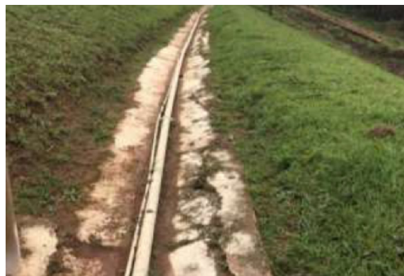
Figura 69- Canaleta de drenagem superficial na B I com danos no concreto
