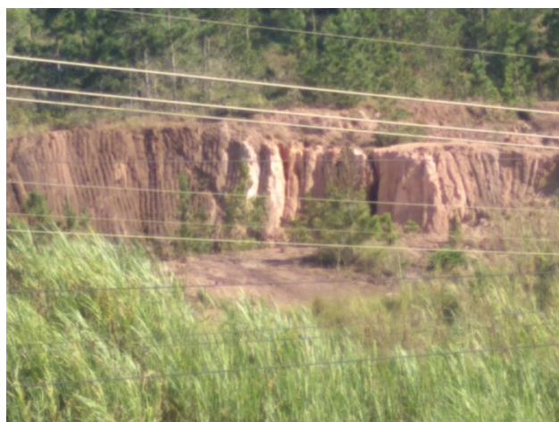
Foto 58: Processo Erosivo no Solo
