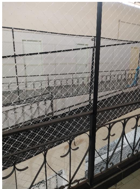
Figura 15 – Rampas com telas de proteção
