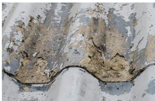
a- Deterioração de TCA
