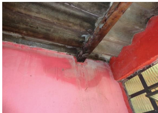
b - TCA com ponto de infiltração
