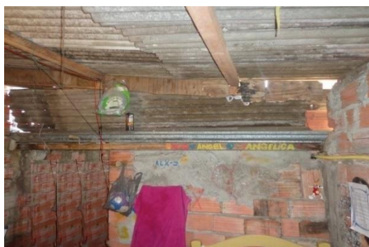
a –TCA em situação precária
