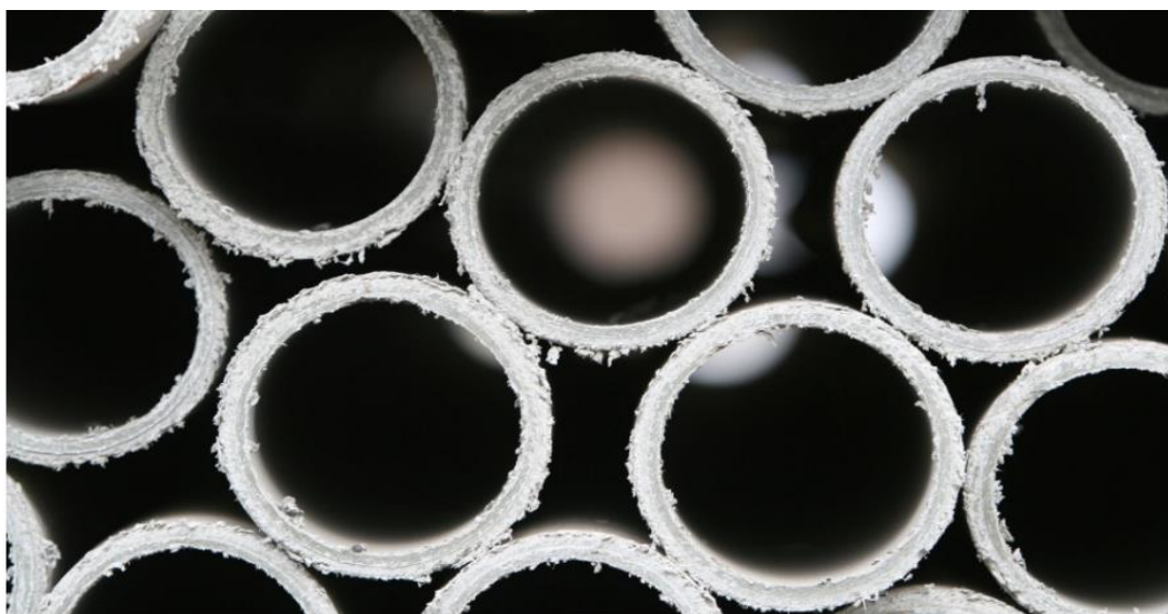
Figura 21- Dutos de cimento-amianto para distribuição de água
