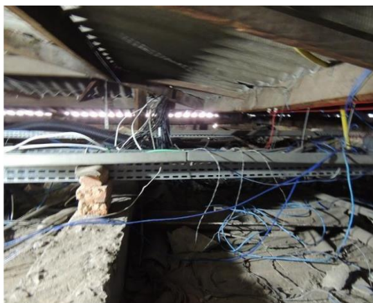
a- Infraestrutura sob TCA
