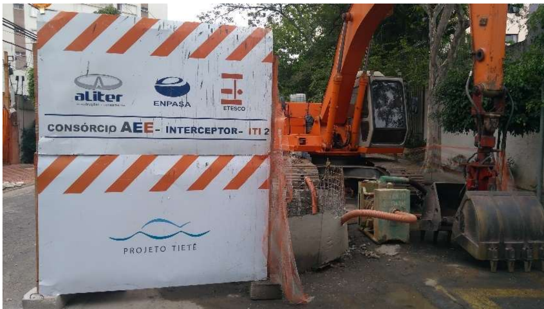
Figura 65: Obras do Interceptor Tietê ITI-2 em trecho da rua Tenente Rocha. Fonte: Elaboração do autor, 2020.
