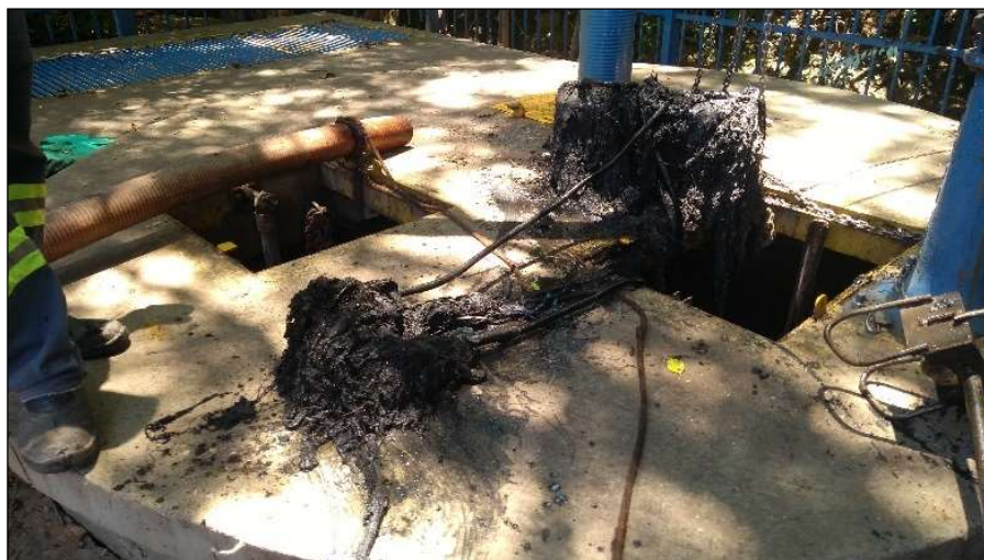
Figura 64: Acúmulo de resíduos na bomba da EEE do córrego Tenente Rocha. Fonte: Elaboração do autor, 2020.
