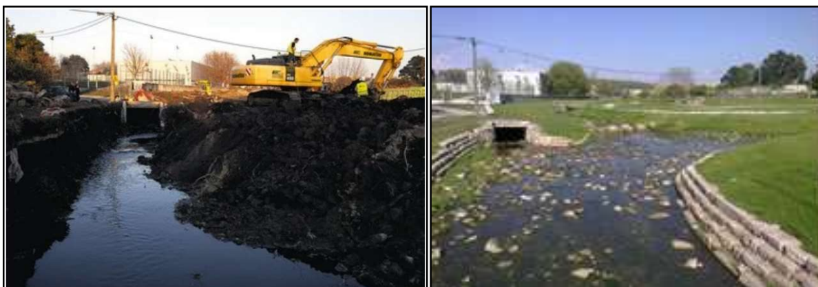
Figura 28: Durante e após a reabilitação da ribeira da Granja, Concelho de Vila Nova de Gaia, Portugal. Observa-se a criação de micro açude para o amortecimento das cheias.
