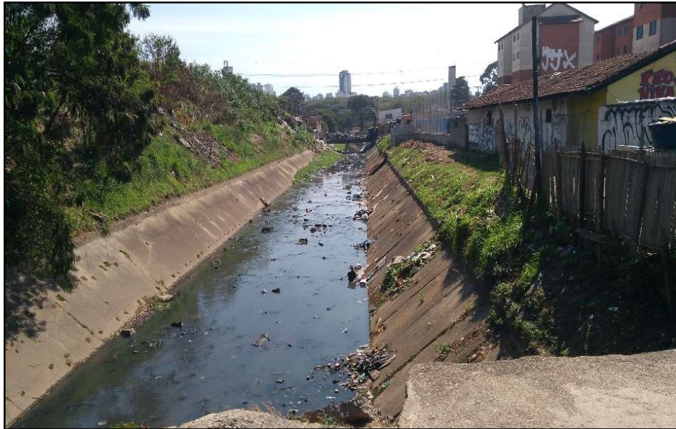
Figura 12: Canalização em fundo de concreto no córrego Carandiru, Zona Norte de São Paulo. Fonte: Elaboração do autor, 2019.
