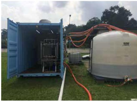
Figura 10 - Equipamento SBNANO2 instalado em um contêiner
