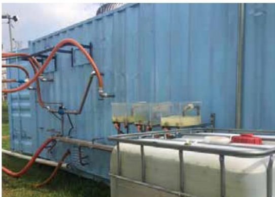
Figura 11 - Vista lateral do contêiner mostrando as tubulações de entrada e saída no gerador de nanobolhas SBNANO2
