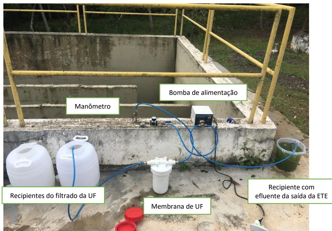
Figura 31. Sistema de ultrafiltração instalado na saída da ETE RJ
