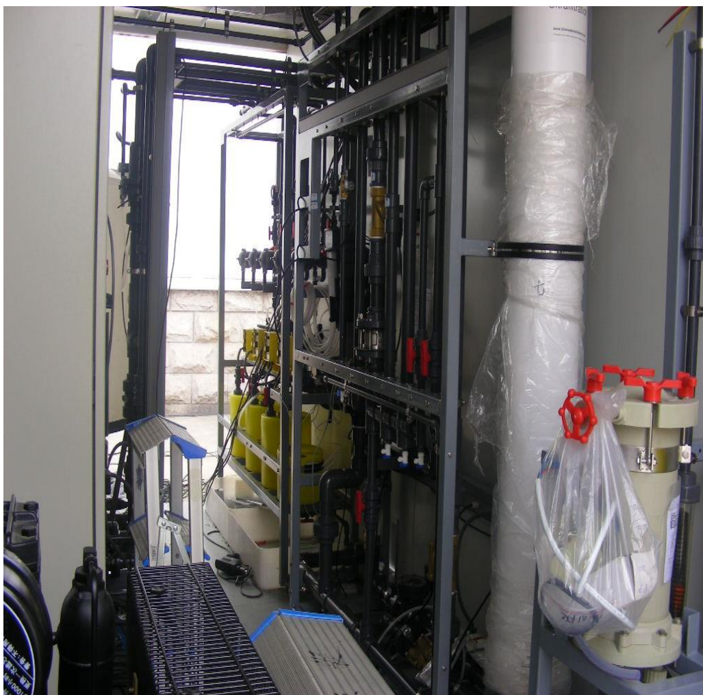
Figura 33: Piloto de ultrafiltração, instalada em container
