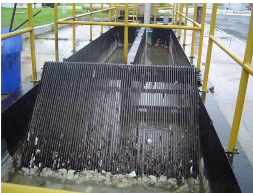
Figura 12. Exemplo de um gradeamento na entrada de estação de tratamento de esgoto
