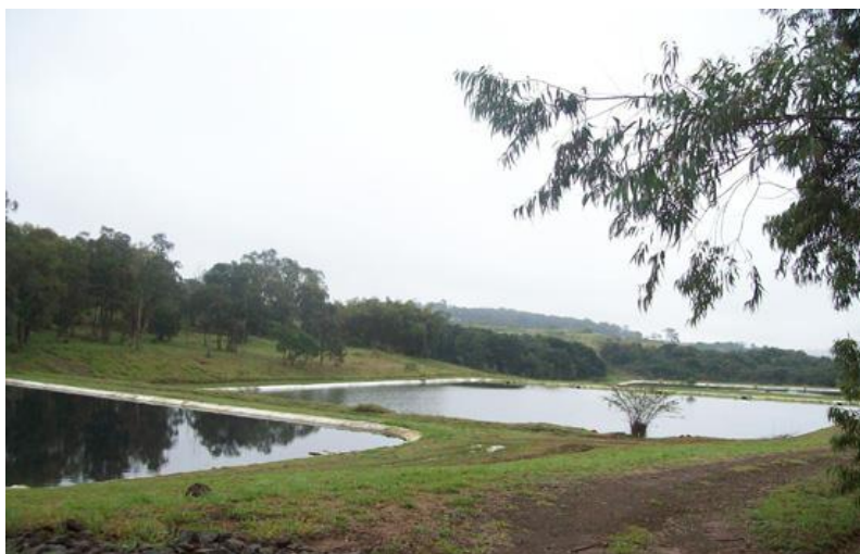
Figura 29: Foto das lagoas de estabilização da ETE RJ
