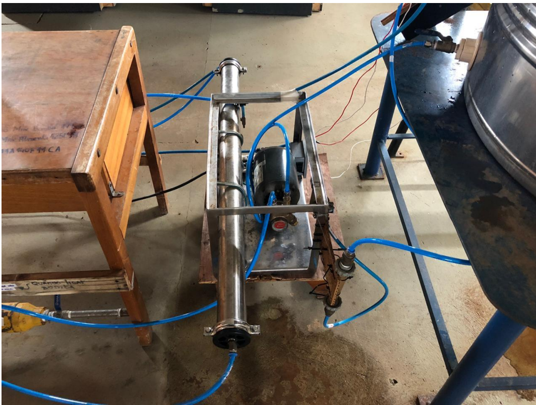
Figura 34: Sistema piloto de nanofiltração
