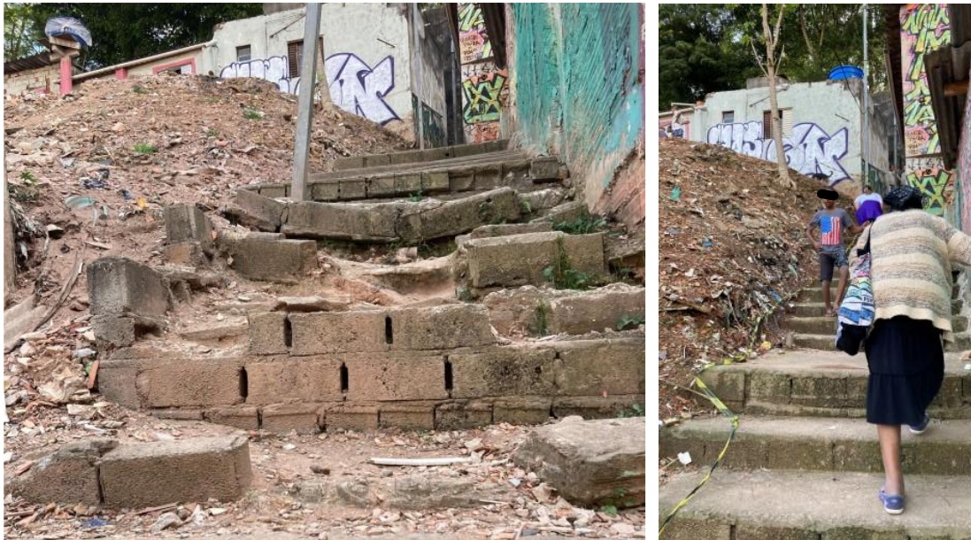
Figura 29: Escada danificada e com alto declive no território. Fonte: Nilton Stanguini.
