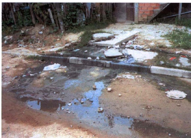
Figura 1. Extravasão de esgoto na via pública devido a um entupimento na rede.
