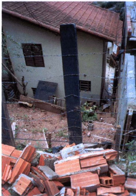
Figura 41. Interferência entre a tubulação de água potável e a caixa de inspeção no corredor lateral da moradia. Notar também o assoreamento do quintal.
