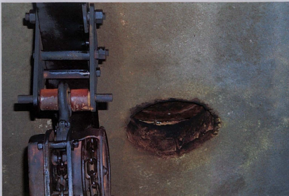
Figura 43: Foto do teto da cabina com uma abertura por onde era perdida boa parte da exaustão do sistema de ventilação
