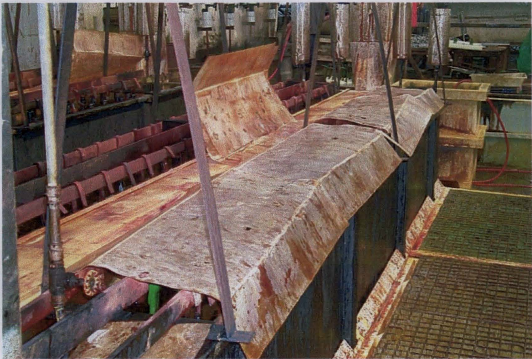
Figura 47: SVLE com tampa de fibra de vidro cobrindo os tanques eletrolíticos na empresa E 06
