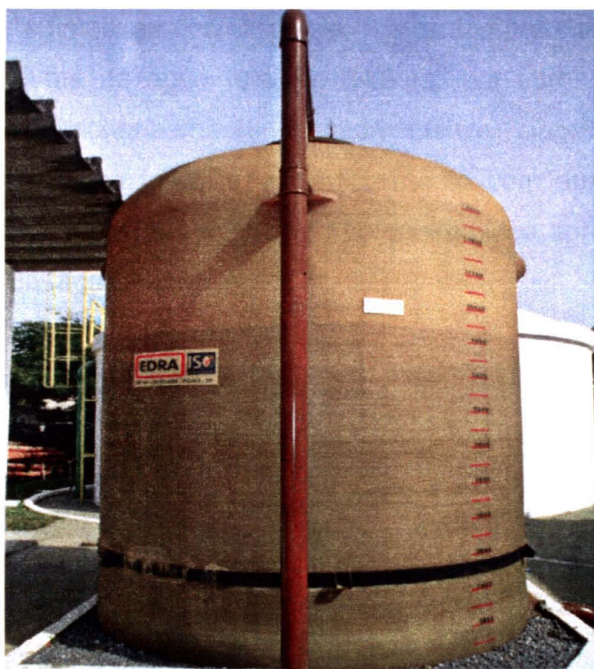
Figura 6.8 Tanque de equalização.
