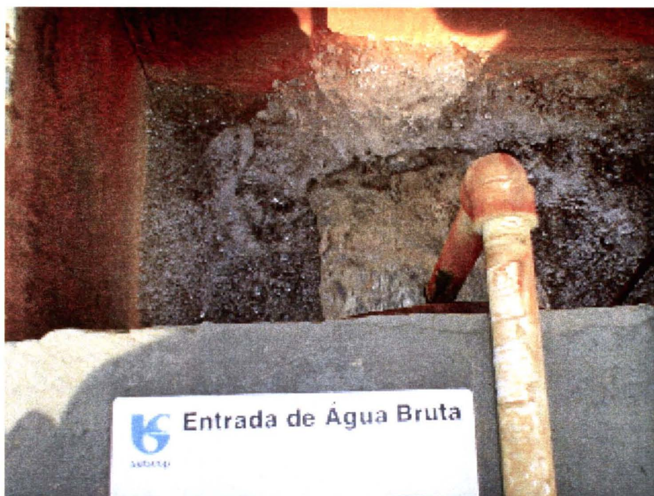
Figura 6.4 Entrada de água bruta.
