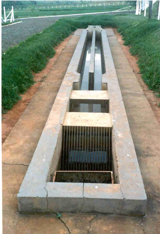
Figura 61 - Detalhes do sistema de gradeamento e caixa de areia. Pré-tratamento da planta de tratamento de Populina.
