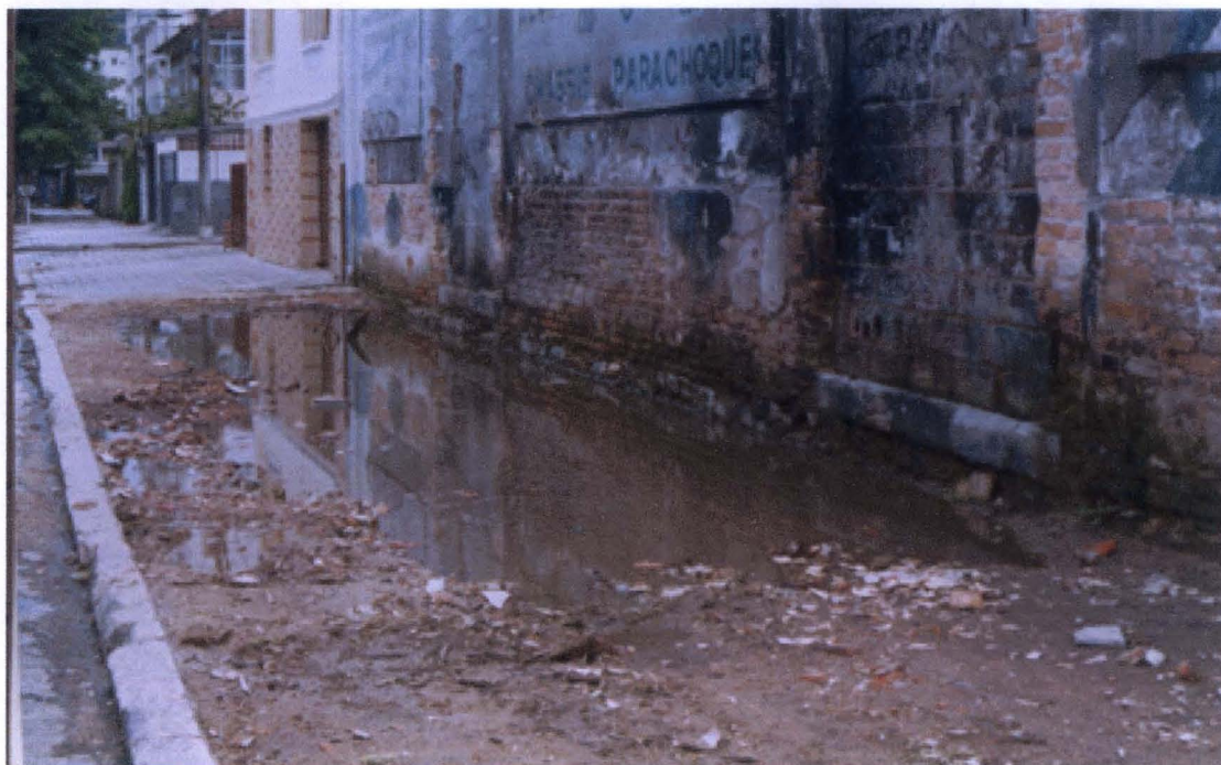
Figura 13 – Área onde foi efetuada remoção de material, mostrando estado da calçada e empoçamento d'água.
