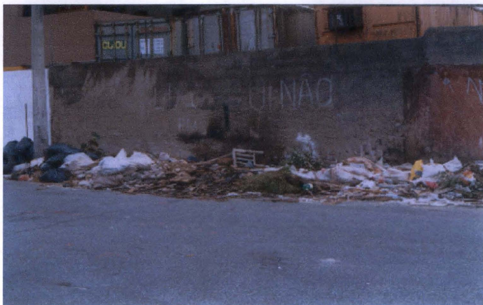
Figura 15 – Muro com marcas de chama que indicam o problema referente à queima dos resíduos.
