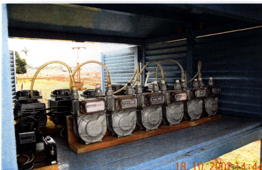
Figura 23. Vista interna da casinha de proteção do trem de amostragem, com as 6 bombas de vácuo e os 6 gasômetros calibrados.
