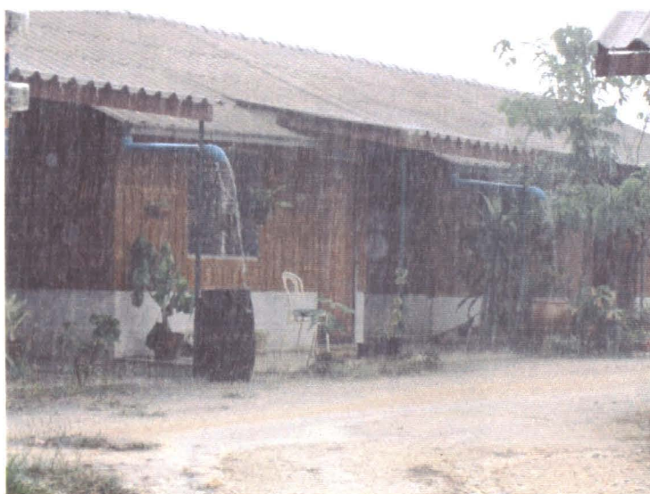
Figura 4.6.1.1: Flagrante de captação feita diretamente das coberturas.
