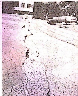
Há rachaduras até no piso.
