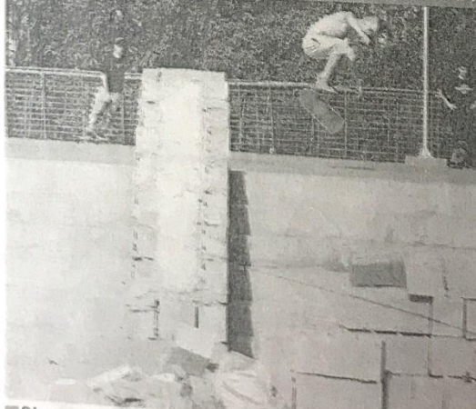
Obra na praça Roosevelt, no centro de SP; local terá 1.150 metros quadrados só para a prática do esporte
