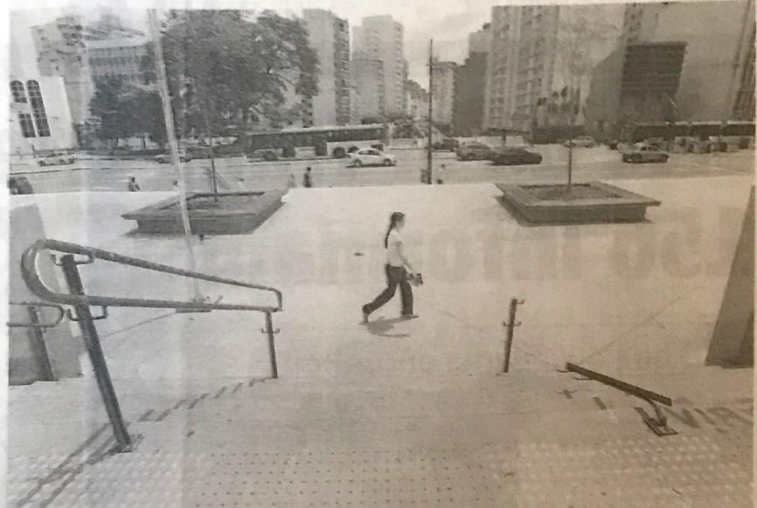
Corrimão quebrado de escada da praça Roosevelt, na Consolação, na região central da capital, um ano após reinauguração do espaço; local passou por reforma que custou R$ 55 milhões aos cofres públicos
