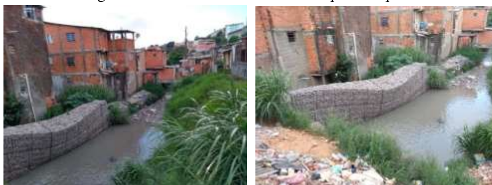
Figuras 6 e 7 – Fotos tiradas do muro que está quase caindo
