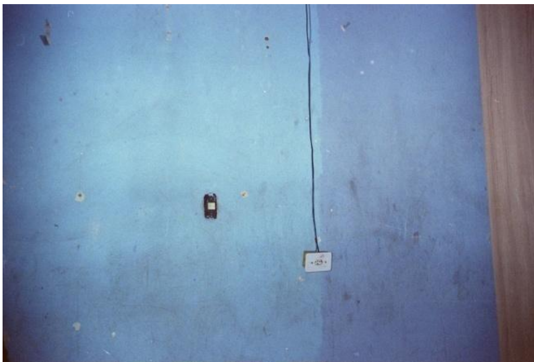
Figura 76- Parede e tomadas
