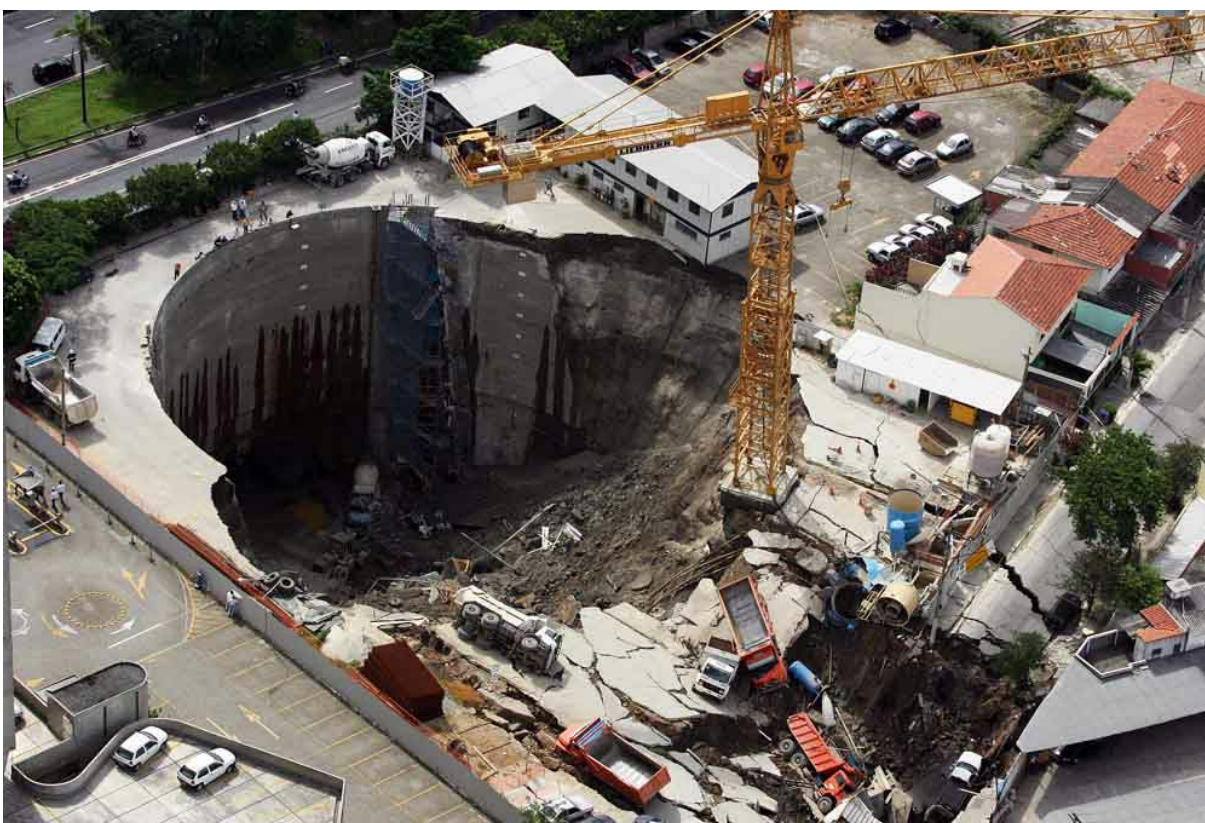
Figura 01. Abatimento da estação Pinheiros do Metrô, em janeiro de 2007 (Fonte: g1.globo.com ).
