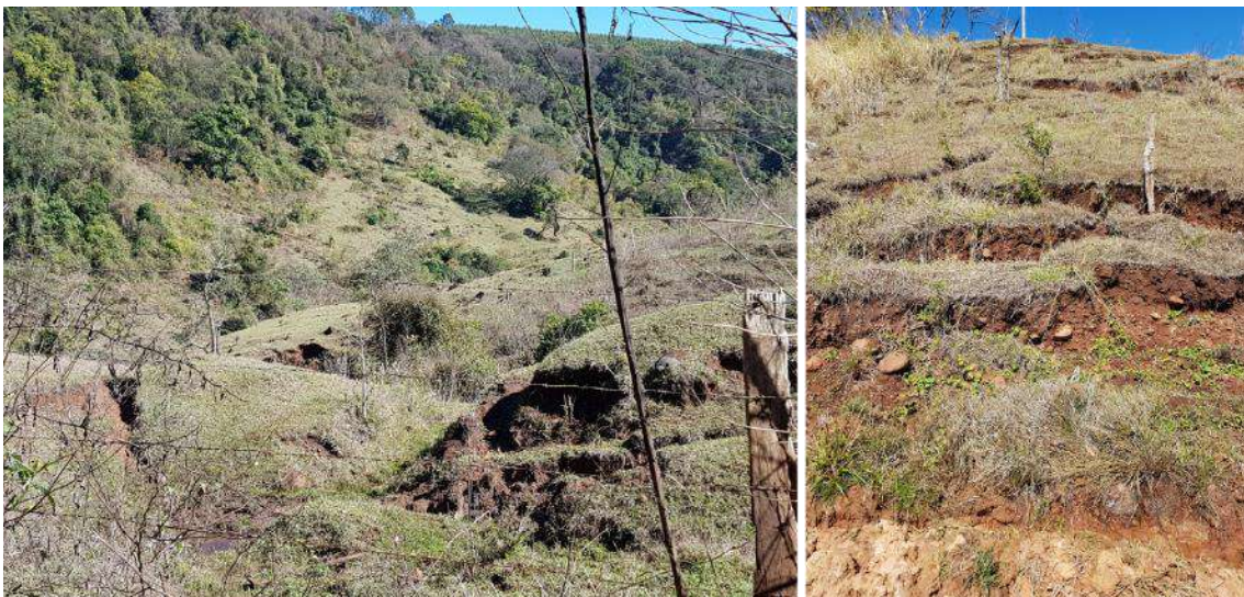
Figura 38 – Padrão escalonado de rupturas em solos residuais de basaltos ao longo das encostas na região de topo da serra.
