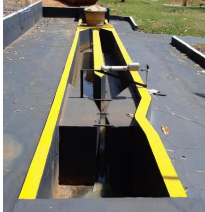
Figura 18. Calha Parshall instalada na entrada do sistema de esgoto da cidade (ETE)
