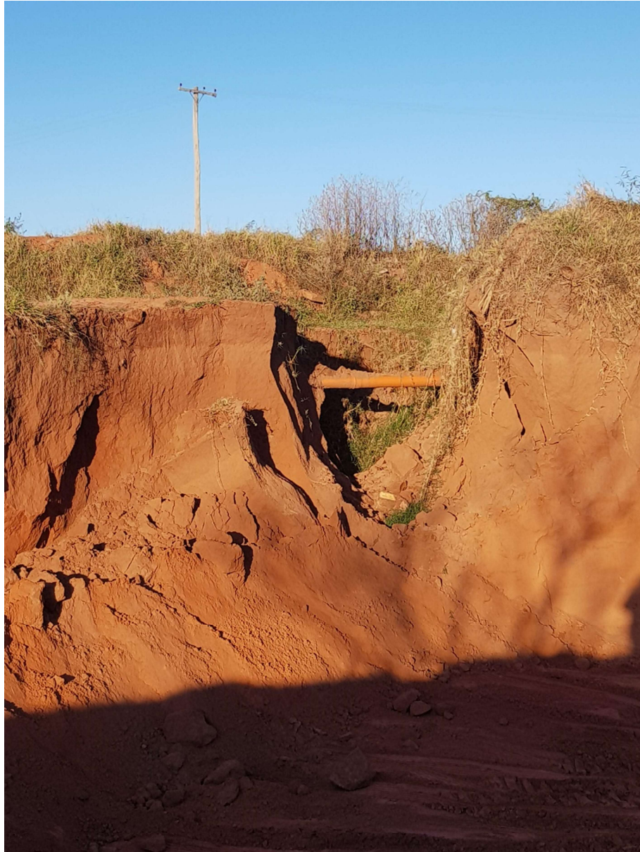
Figura 35 – Erosão expondo tubulação de captação de água dos bairros (ago./2021).
