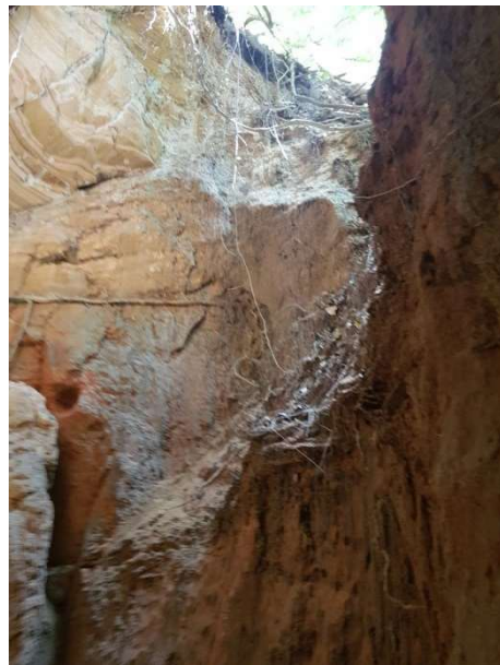
Figura 58b – Vista de dentro do pipe , com teto abatido.
