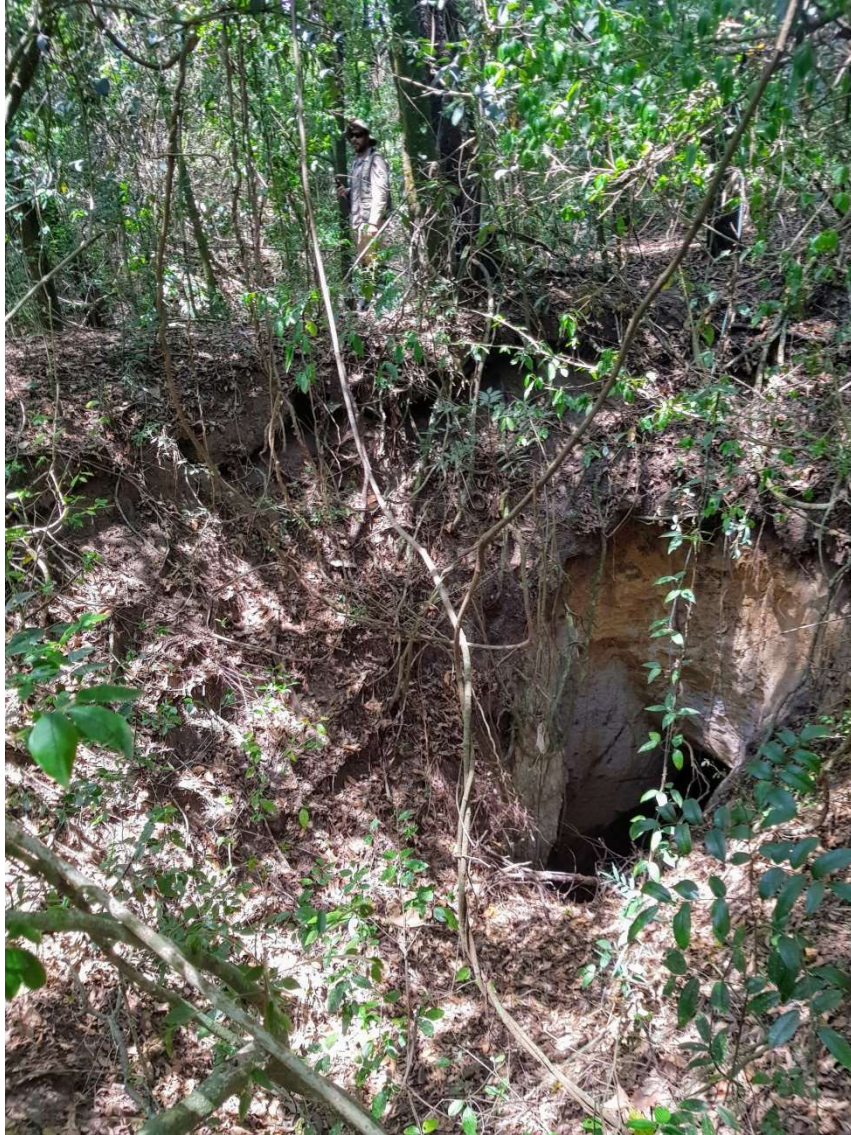
Figura 3 – Colapso total, abatimento de teto de uma porção do pipe na área de pesquisa (out./2019).
