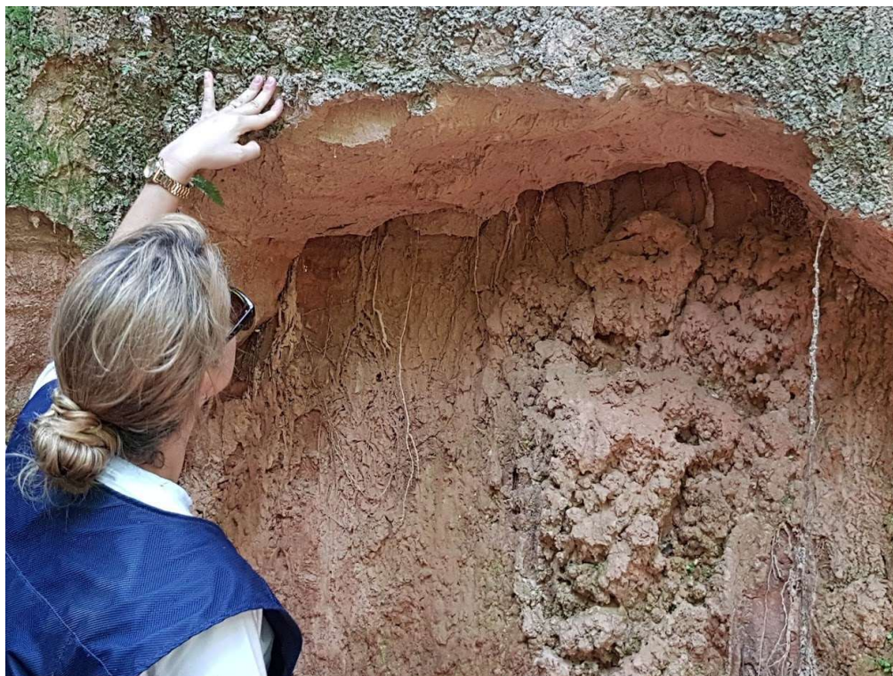
Figura 4 – Detalhe para um escorregamento na lateral da voçoroca (out./2019).
