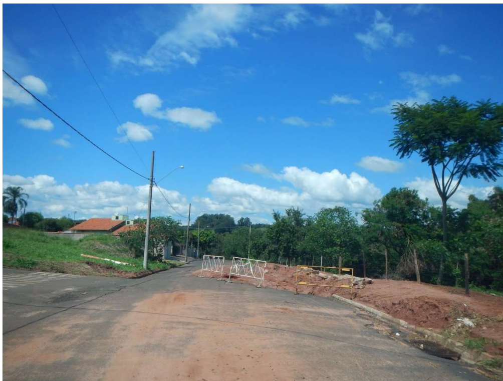
Figura 36 – Erosão causada pela chuva no Jardim Modelo (2016).
