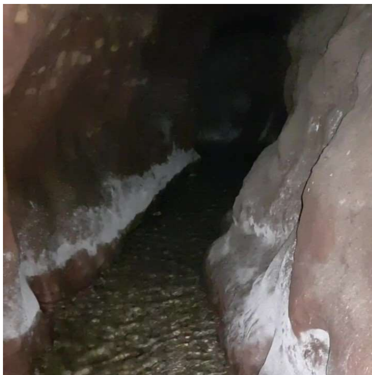
Figura 2 – Água fluindo por fendas de 1,20m por 0,50m abertas pelo processo de piping na área de pesquisa(mar./2020).
