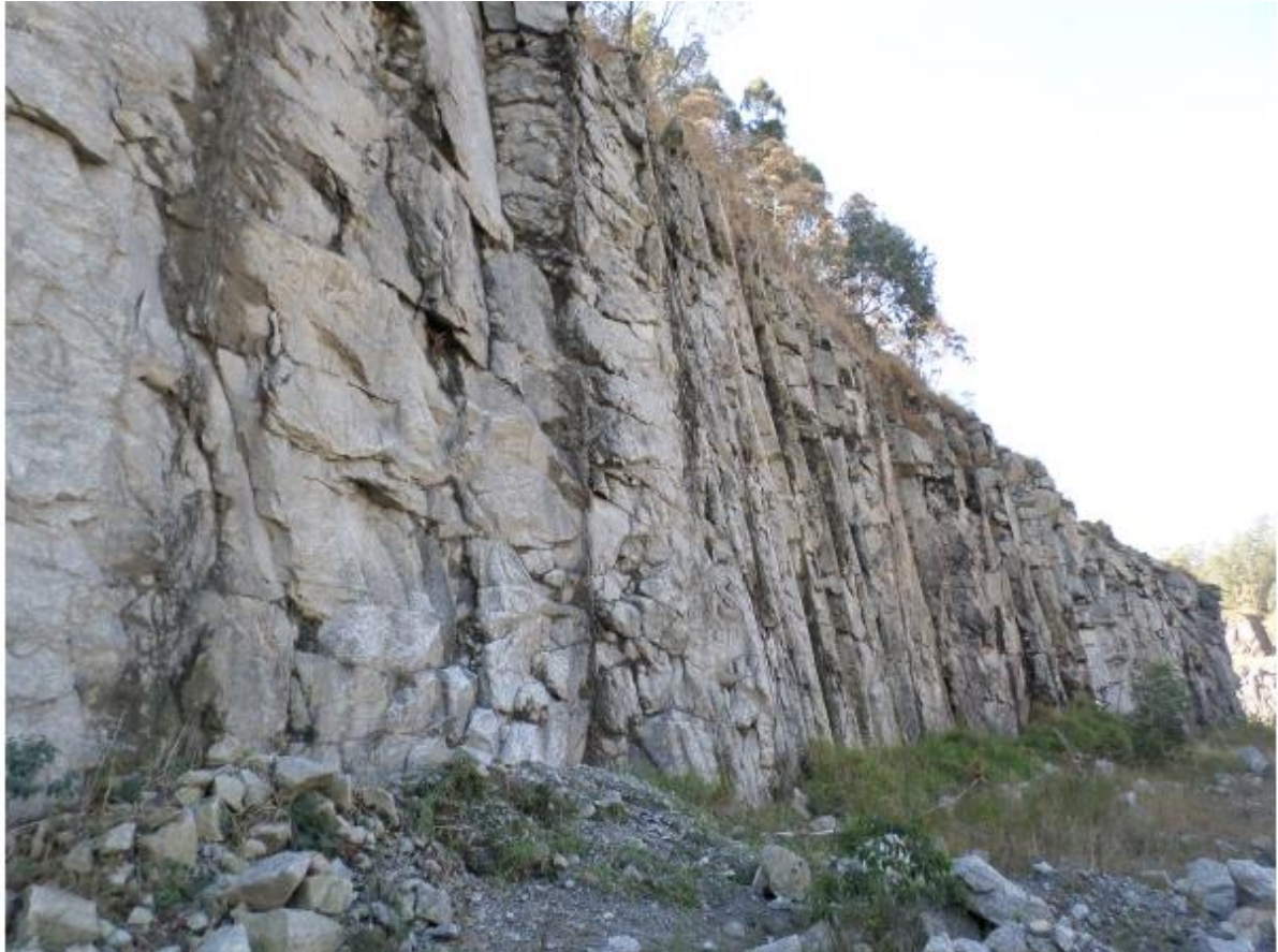
Figura 129 - Zona de Juntas da família 1 na SL ITP-26, fraturas com atitude média de 138/78.
